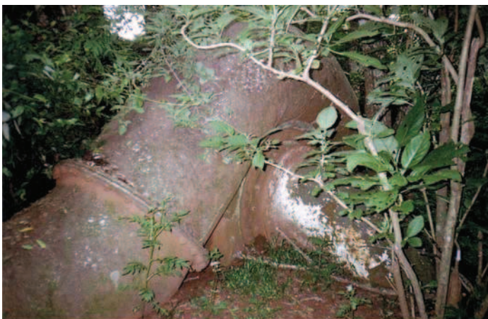
Figura 10 - Usina Sociedade Força e Luz Constantina Ltda – Turbina
