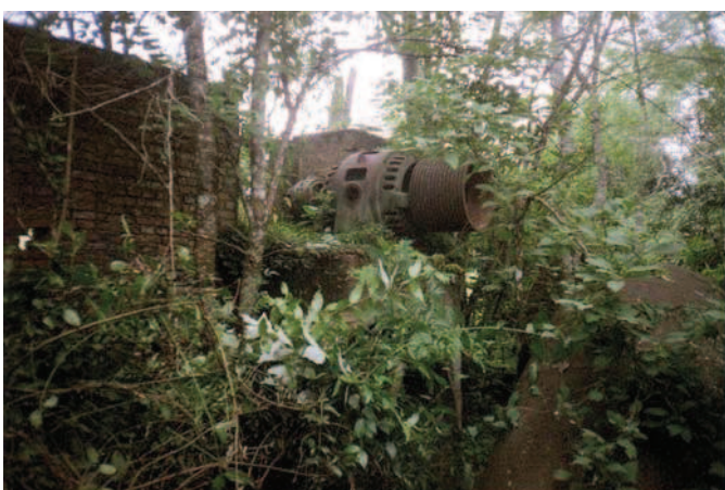
Figura 9 – Usina Sociedade Força e Luz Constantina Ltda – Gerador
