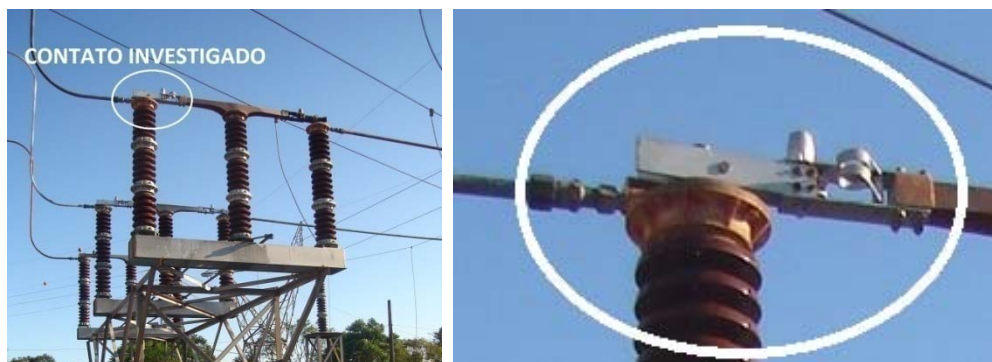
Figura 30 Seccionador instalado na subestação Santa Marta da CEEE GT.
