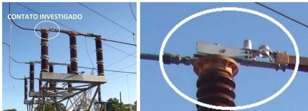
Figura 9 – Seccionador instalado na subestação Santa Marta da CEEE GT.
