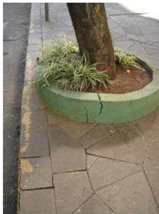
Figura 54 - Rompimento do passeio e do canteiro pela movimentação das raízes
