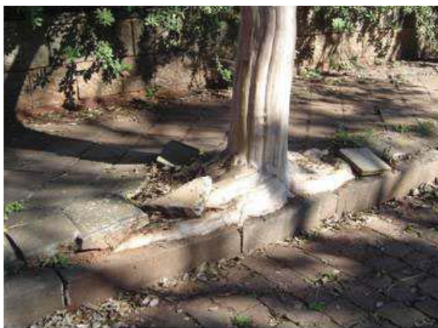
Figura 69 - Raízes ocupando e danificando a área do passeio
