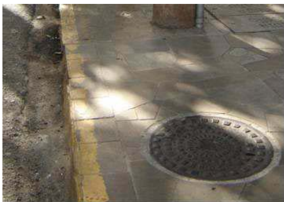
Figura 45 - Tamba poço de visita esgoto da Quadra 01, orientação sul
