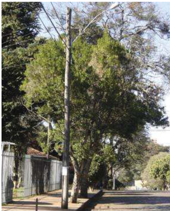
Figura 61 - Vista da Quadra 01, poste de madeira com luminária
