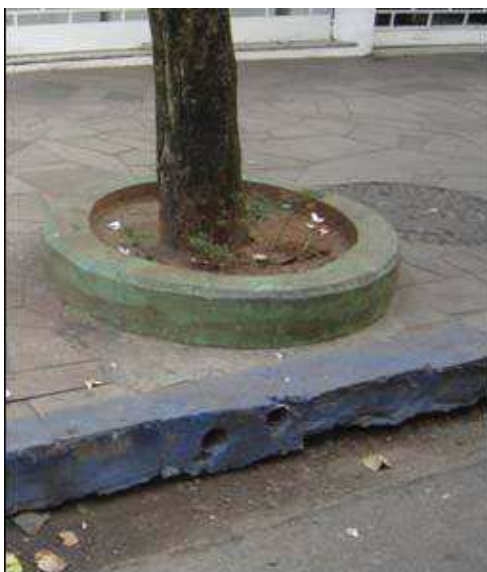
Figura 55 - Elementos registrados na Quadra 01, proximidade da árvore com a tampa do poço de visita
