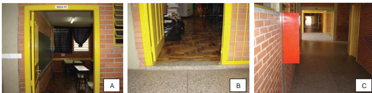
Figuras 85, 86 e 87 - Placa de sinalização tátil em altura inadequada, degrau junto à porta da biblioteca e obstáculo na circulação
