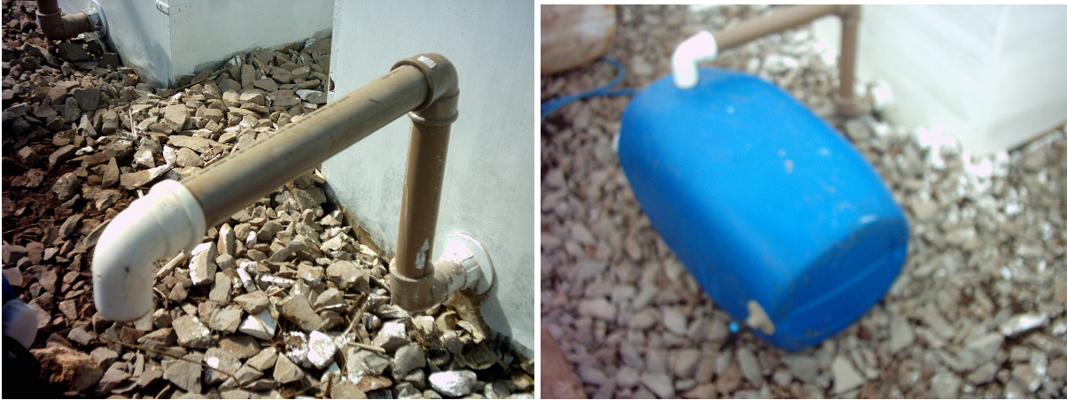
Figura 12 – Tubulação inferior de saída do lixiviado pós-tratado.
