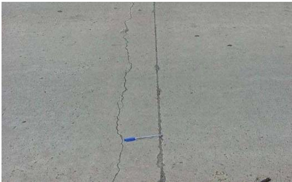
figura 12: Fissura por retração em pavimentação
