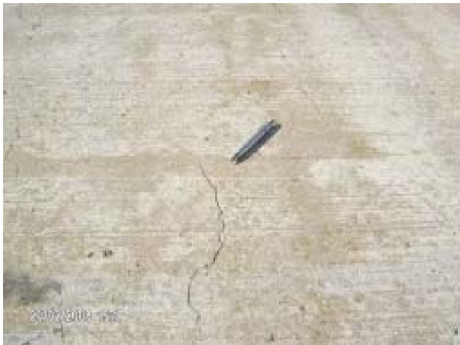
figura 13: Fissura em pavimento de concreto
