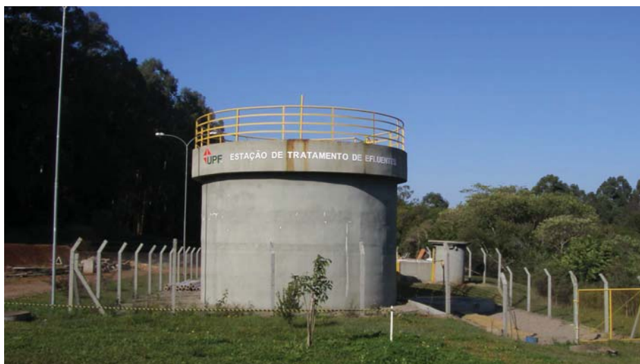
Figura 2, Reator anaeróbio de manta de lodo-UASB- ETE-UPF
