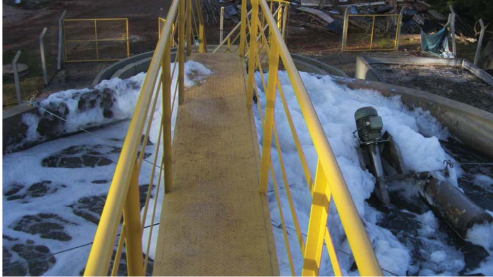
Figura 20: Vista superior do tanque de aeração da ETE-UPF
