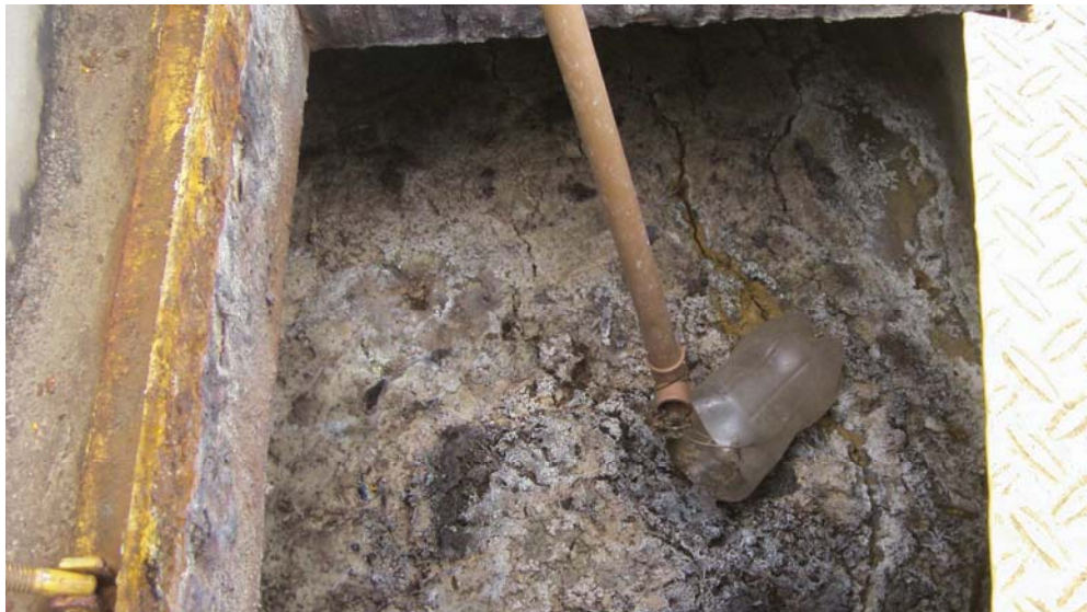
Figura 24, Vista da parte superior interna do UASB
