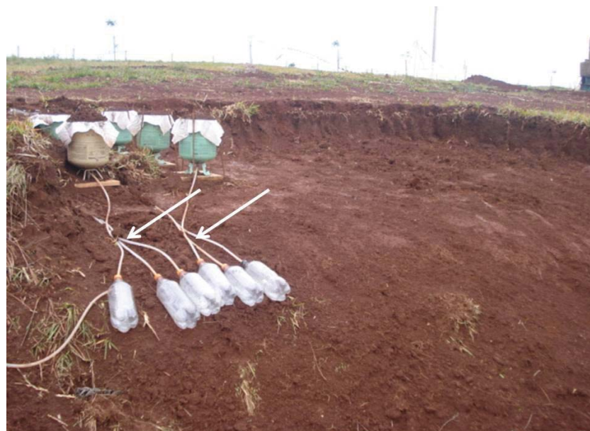
Figura 14: Mangueiras para condução do percolado.
