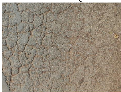
a) Trincas Interligadas
