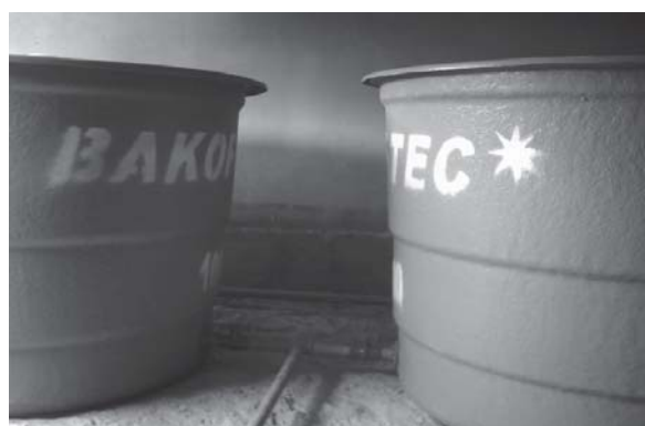
Figura 47 - Reservatórios superiores do prédio dos laboratórios de informática.
