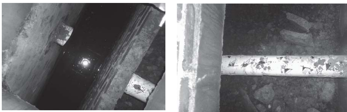
Figura 48 - Fotos do Filtro anaeróbio do sistema de tratamento de esgoto do prédio dos laboratórios de informática.
