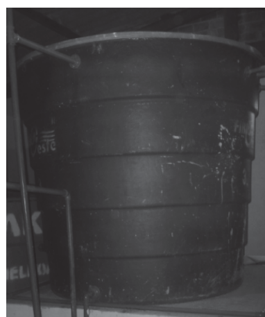
Figura 44 - Reservatório superior do prédio do setor administrativo.
