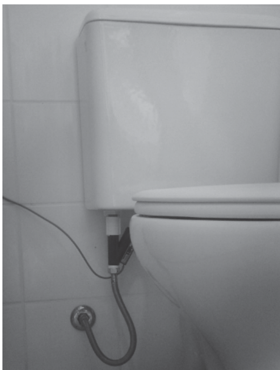
Figura 67 - Chaves de Fluxo instaladas nas bacias sanitárias dos ambientes sanitários do prédio de salas de aula.
