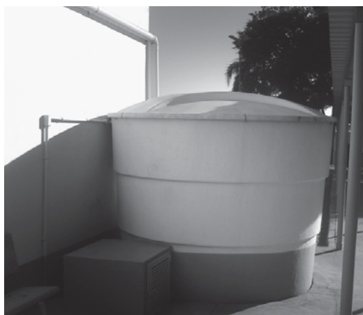
Figura 43 - Reservatório de armazenamento do prédio do setor administrativo
