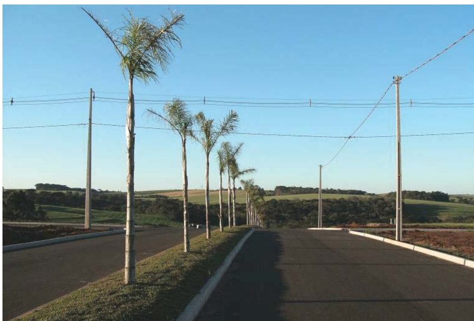
Figura 52 - Rede de energia elétrica do condomínio em estudo.
