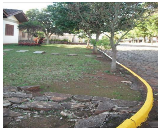
Figura 63: Passeio inexistente na rua Ângelo Cornelli
