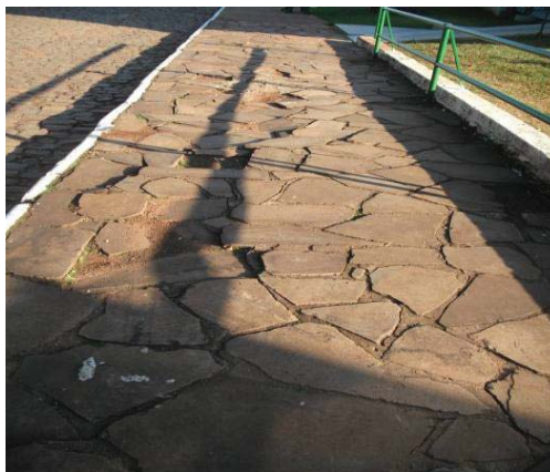
Figura 66: Passeio com defeito na rua Recreio
