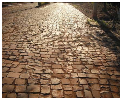
Figura 68: Pavimentação danificada rua Duque de Caxias
