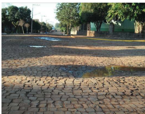
Figura 67: Pavimentação danificada na avenida Julho de Castilhos
