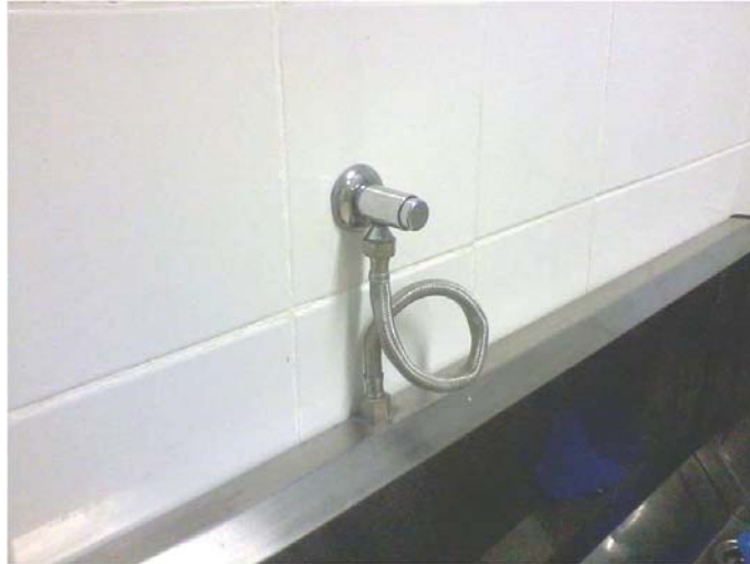
Figura 80: Mictório com acionamento hidromecânico com leve pressão manual e fechamento automático.
