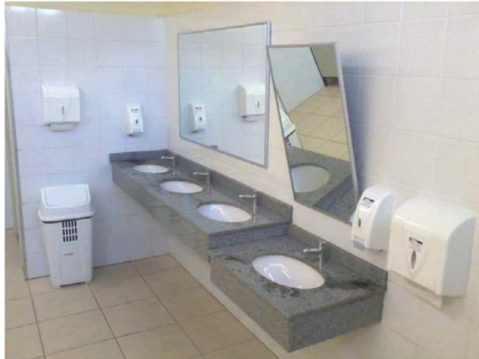
Figura 79: Torneiras com acionamento hidromecânico com leve pressão manual e fechamento automático.
