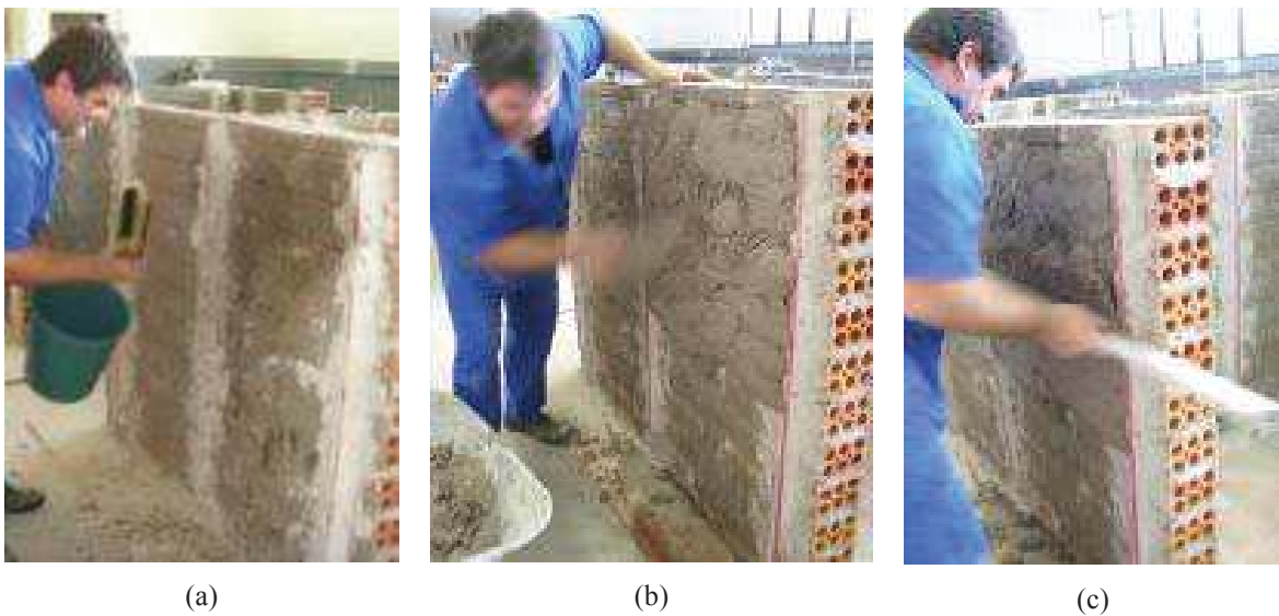
Figura 33 Execução do revestimento: (a) umedecimento do chapisco; (b) aplicação da argamassa; (c) sarrafeamento.
