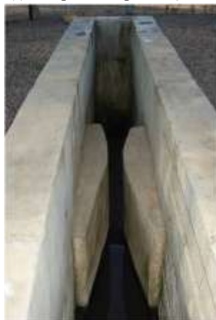
(i) Saída para o corpo hídrico
