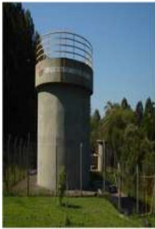
(a) Vista frontal da ETE
