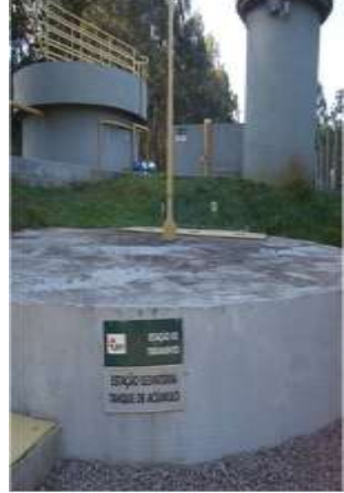
(f) Tanque de equalização
