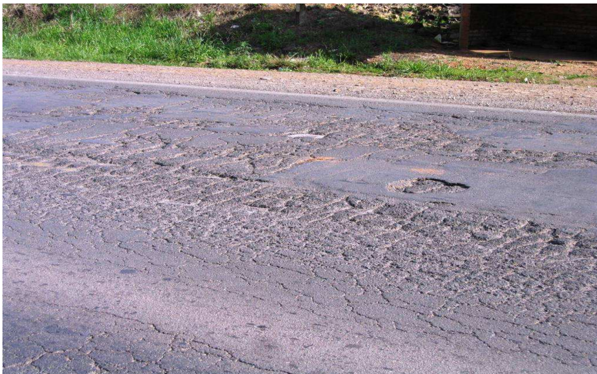
Figura 16 - Trincas Classe III , no trecho entre as cidades de Casca a Marau.
