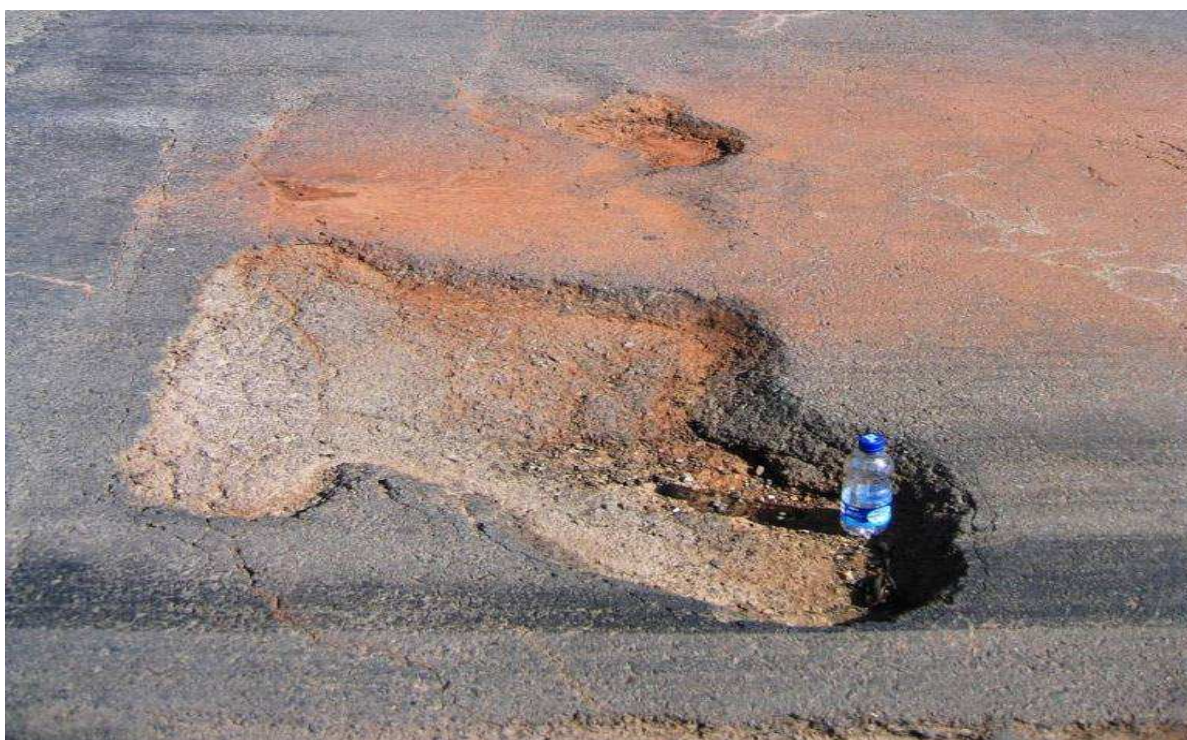
Figura 19 - Defeito tipo “panela” de grande extensão e profundidade
