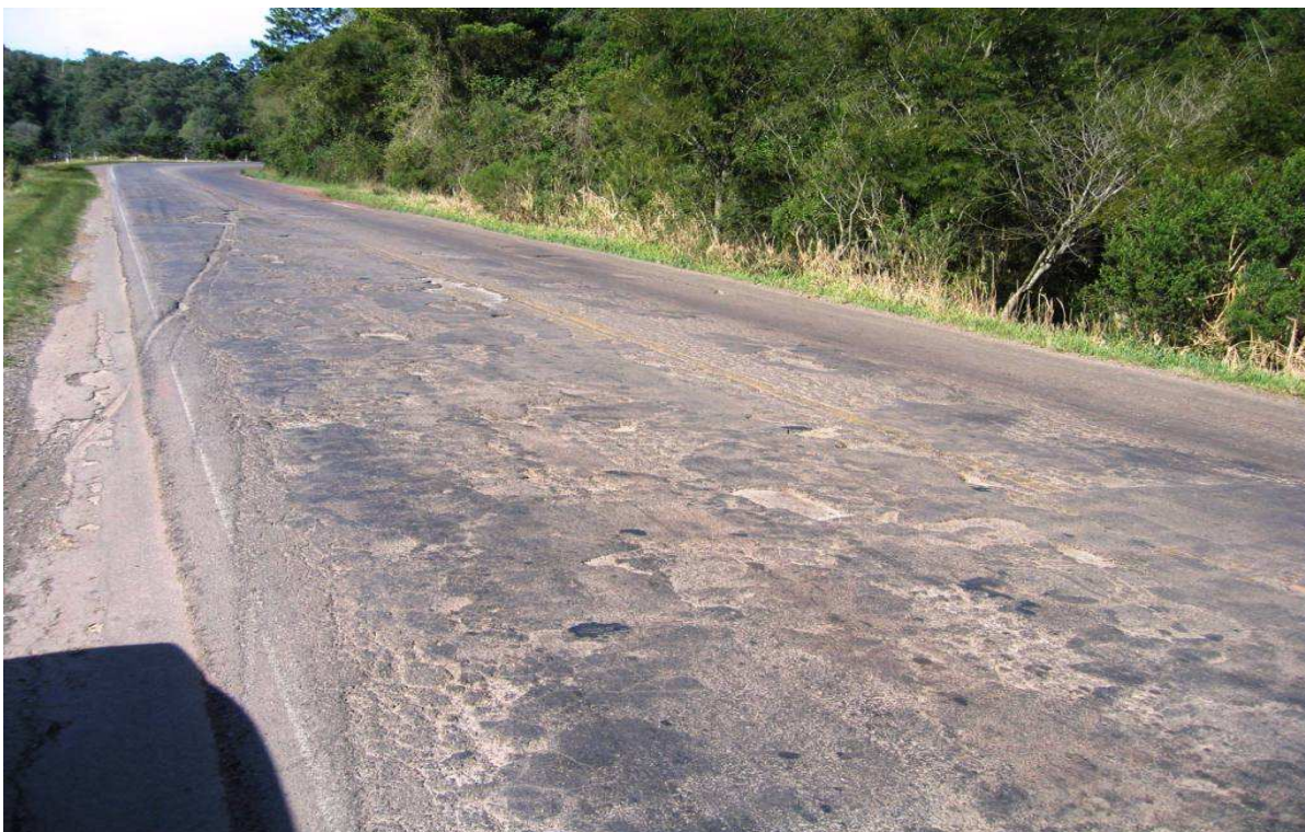
Figura 20 - Pavimento deteriorado, no trecho entre as cidades de Casca a Marau.
