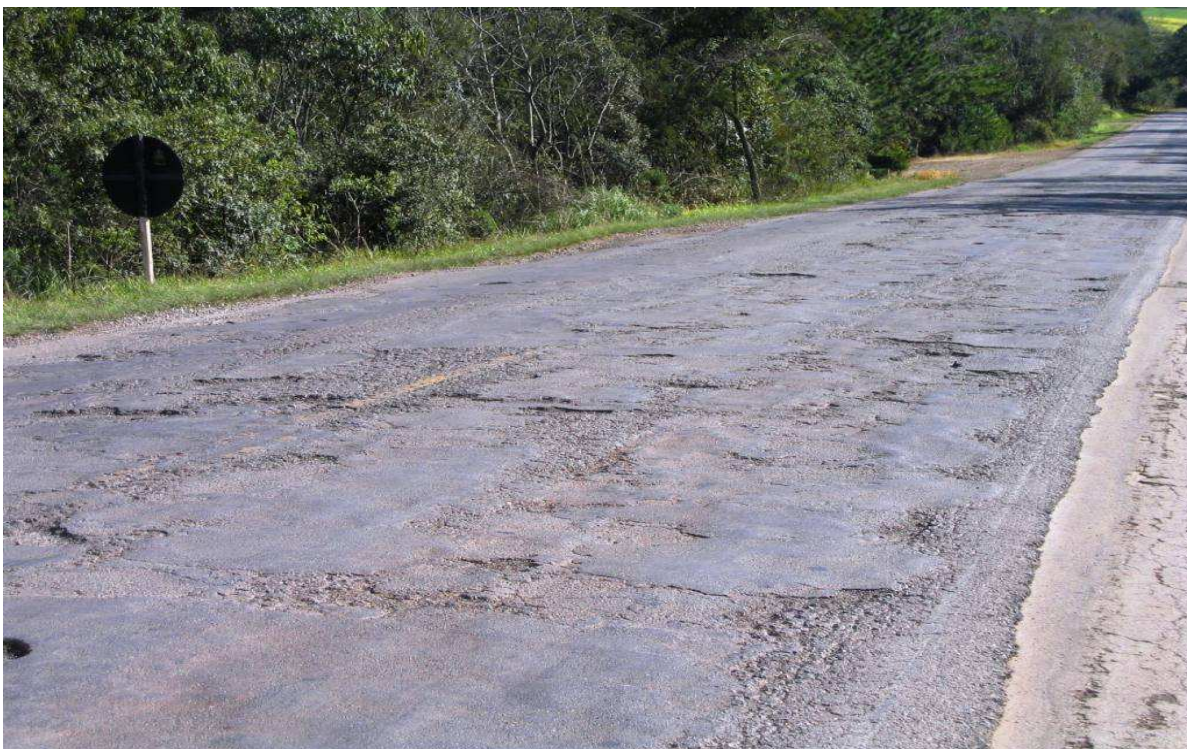
Figura 21 - Pavimento deteriorado no trecho entre as cidades de Casca a Marau.
