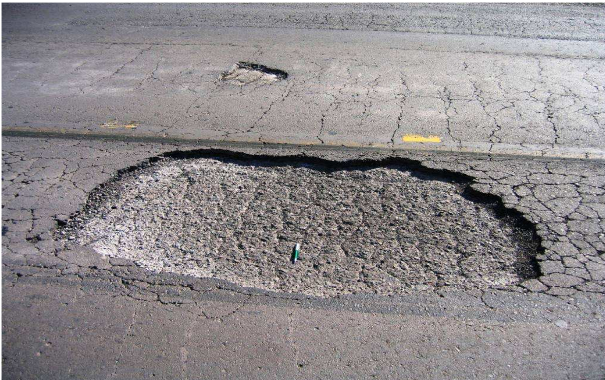
Figura 24 - Defeito tipo “panela” de grande área
