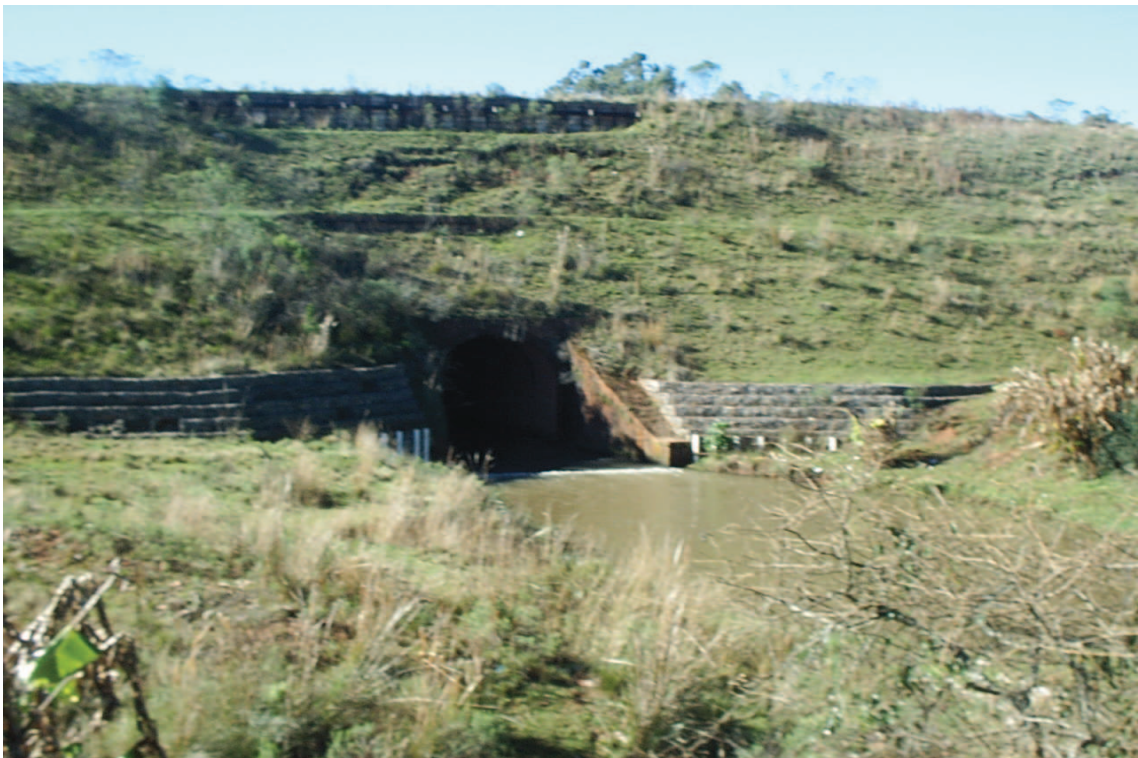
Figura 22. Estrangulamento do leito do rio Passo Fundo (aterro da rede ferroviária)
