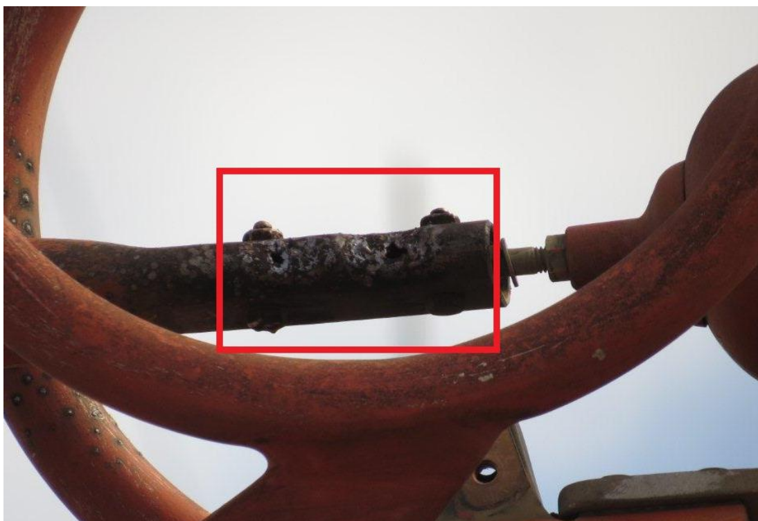
Figura 8 - Problema de aquecimento no contatos da lâmina principal
