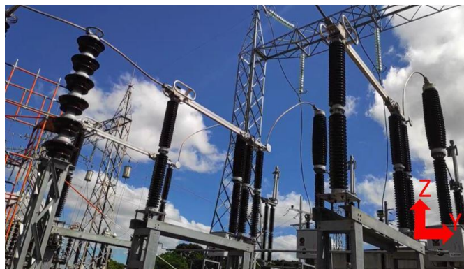
Figura 30 - Chave seccionadora de abertura vertical em subestação
