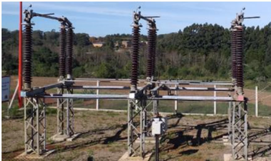
Figura 48 - Chave seccionadora Lorenzetti 242kV trifásica
