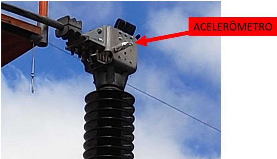
Figura 55 - Acelerômetro instalado no contato fixo da chave seccionadora
