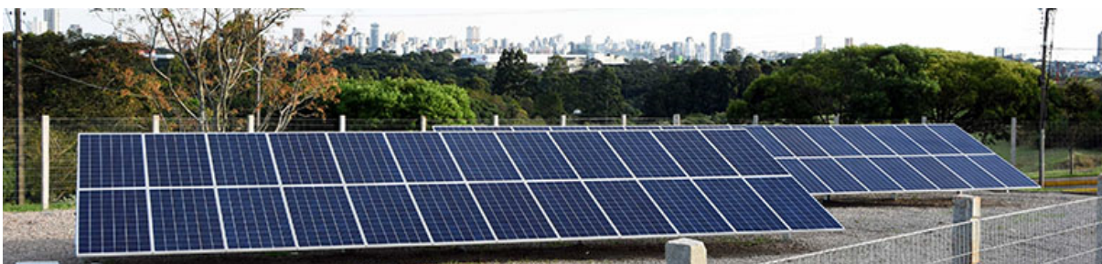
Figura 28 – Parque solar fotovoltaico UPF.
