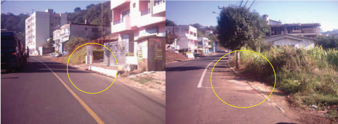
Figura 25 - Demonstra as reais condições disponibilizadas à circulação de pedestres na Rua Antônio Nunes Varella.
