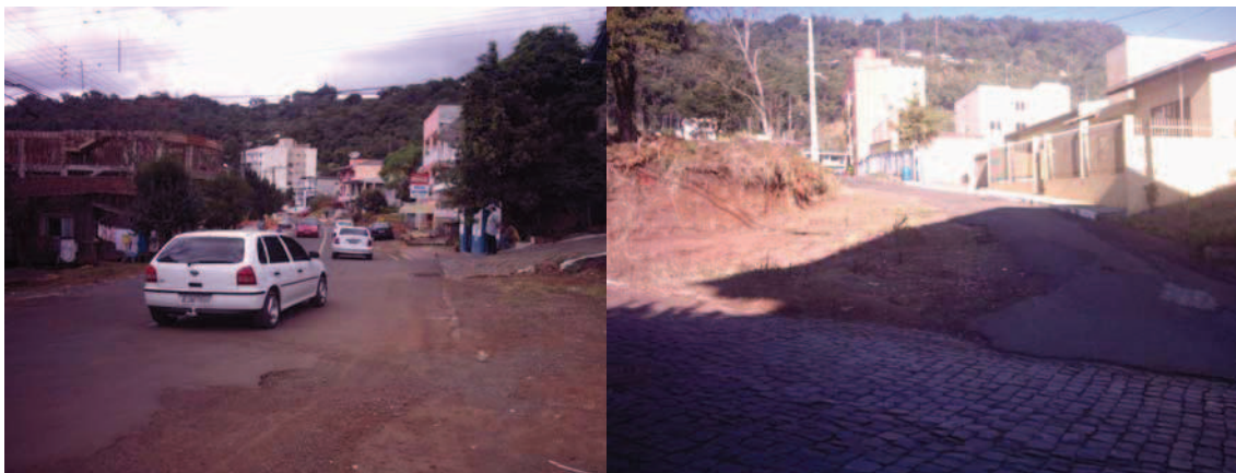
Figura 24 - Estado de trechos da pavimentação do bairro. Fonte: Arquivo pessoal, 2006.
