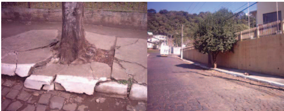
Figura 34 - Ligustro isolado marginal da Rua Achilles Pedrini e piso do passeio danificado pela arborização. Fonte: Arquivo Pessoal, 2006.
