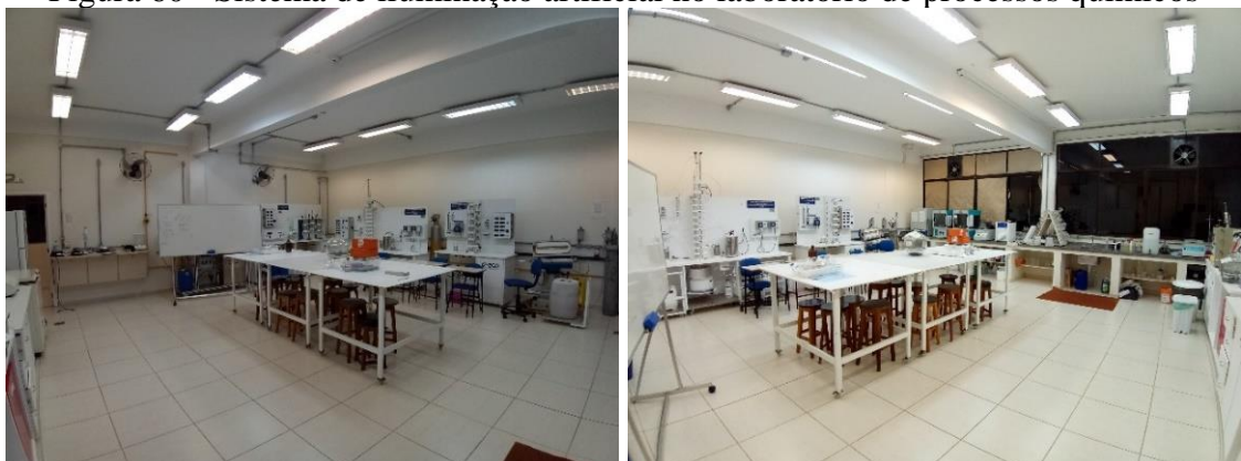
Figura 60 - Sistema de iluminação artificial no laboratório de processos químicos
