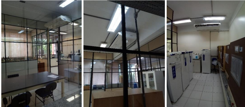
Figura 29 – Climatizadores do edifício L1
