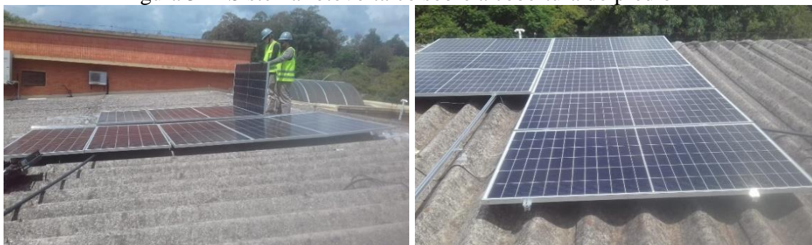
Figura 31 - Sistema fotovoltaico sobre a cobertura do prédio L1
