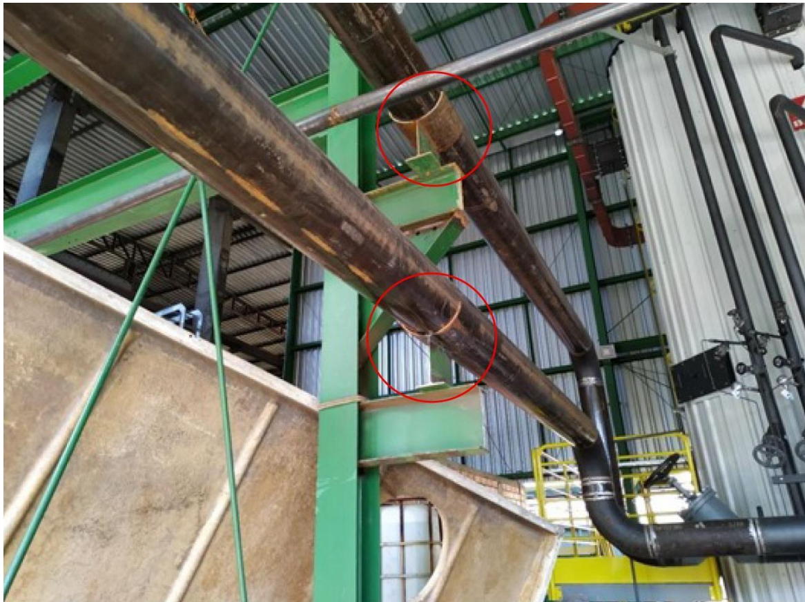
Figura 10: Foto de tubulações de óleo térmico em uma indústria de biodiesel
