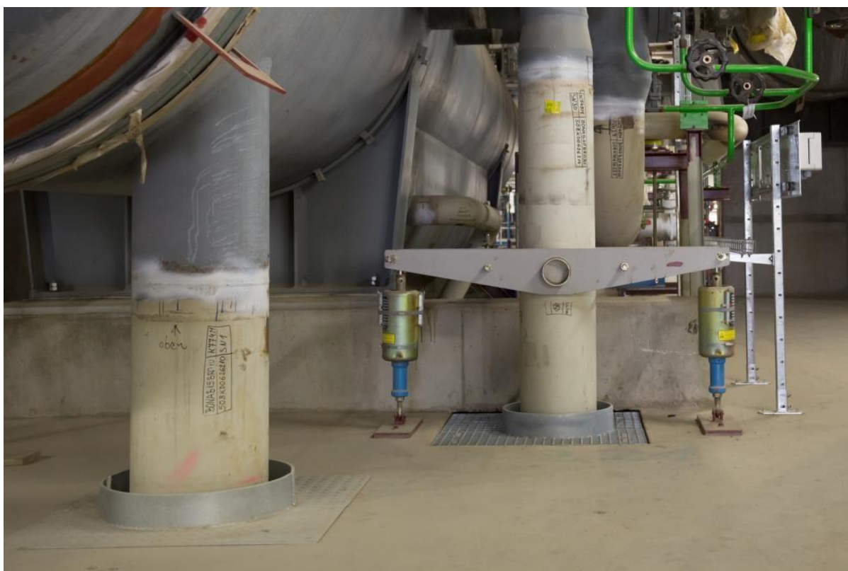
Figura 12: Suporte de mola para tubulação
