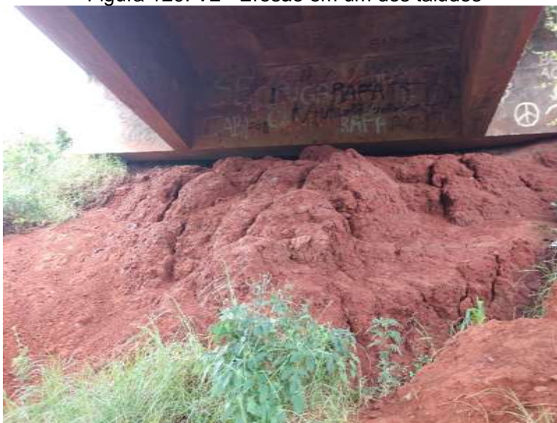
Figura 120: V2 - Erosão em um dos taludes
