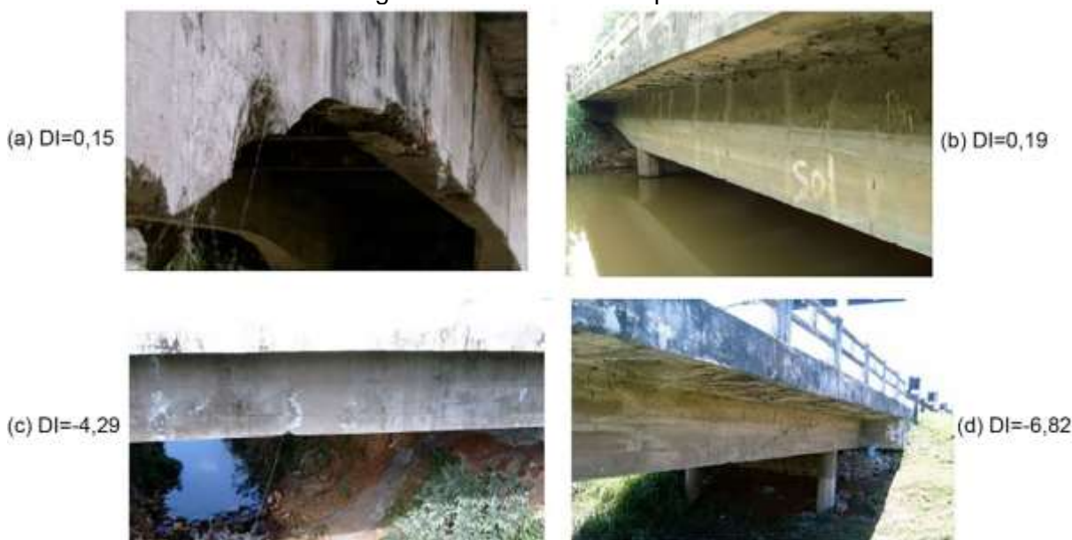
Figura 24: DI e danos em pontes
