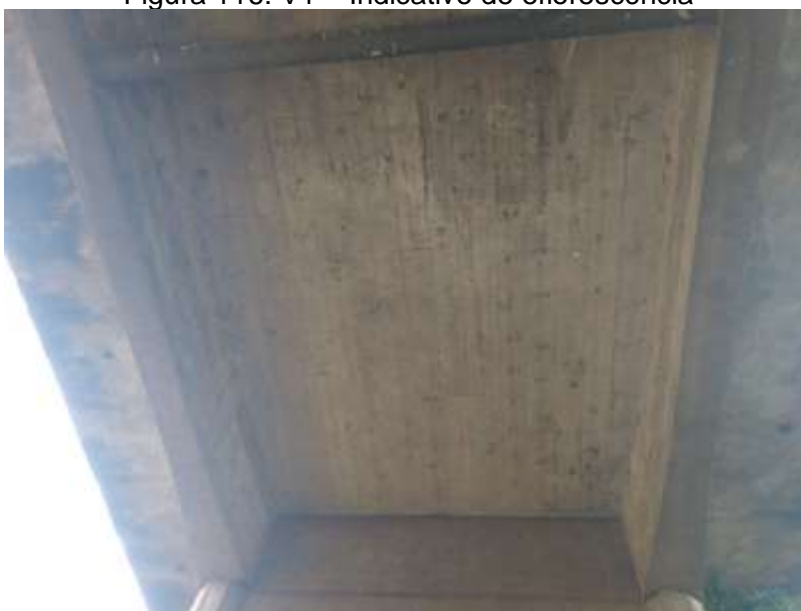
Figura 116: V1 – Indicativo de eflorescência
