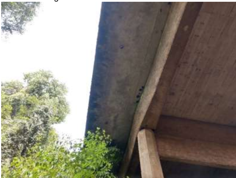
Figura 115: V1 - Manchas de umidade
