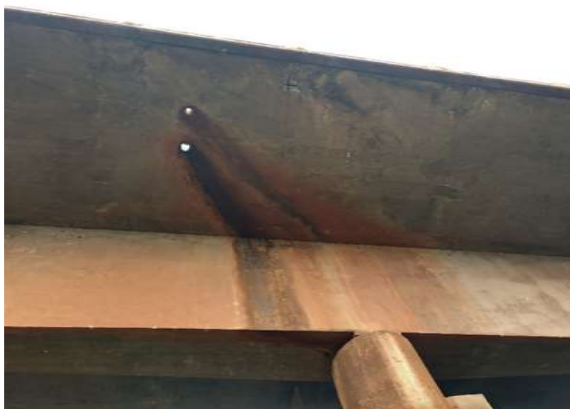
Figura 117: V2 - Manchas de percolação e armaduras expostas no tabuleiro
