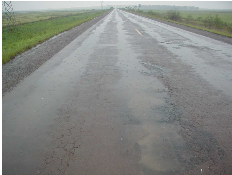
Figura 3: Afundamento em trilha de roda (ATR).
