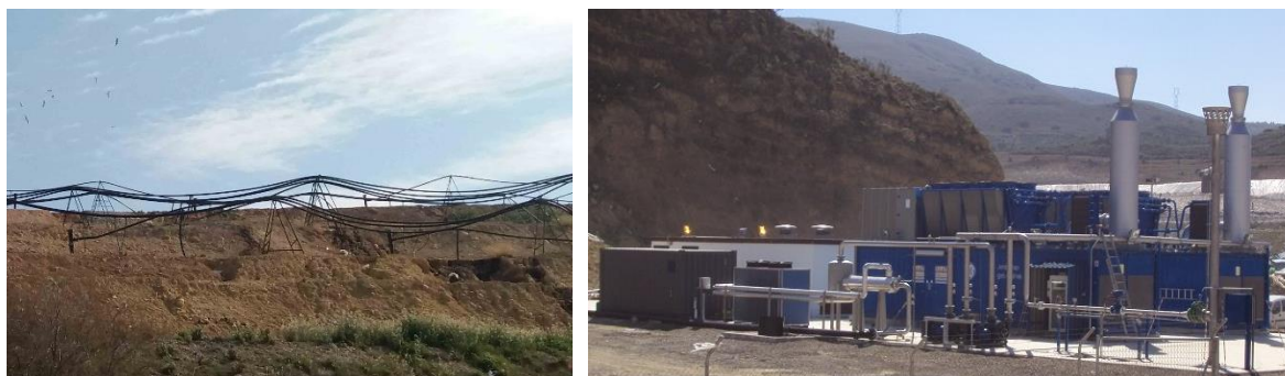
Figura 82: Sistema de aspiração, coleta e condução do biogás do Complejo Medioambiental Valsequillo
