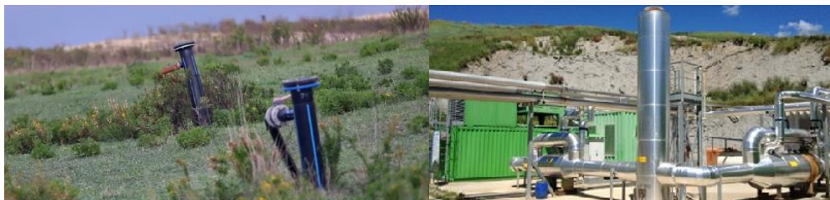
Figura 53: Equipamentos para coleta e produção de eletricidade a partir do biogás
