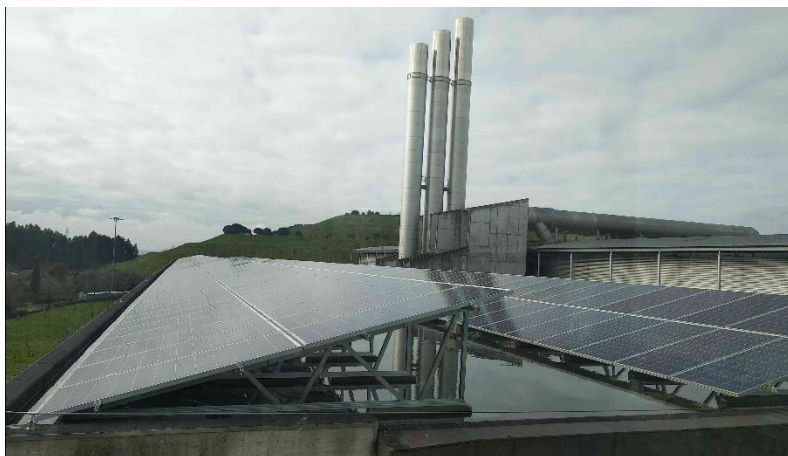
Figura 64: Segunda Central Fotovoltaica do LIPOR
