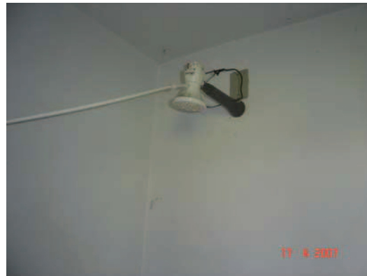
Figura 4.18 – Ambiente sanitário L – Chuveiro.
