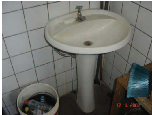
Figura 4.17 – Ambiente sanitário L – Lavatório.
