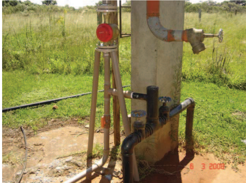
Figura 4.22 – Hidrômetro instalado no sitio aeroportuário Lauro Kurtz.
