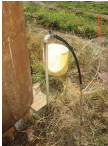
Figura 4.20 - Torneira de lavagem externa do aeroporto Lauro Kurtz, 2008.
