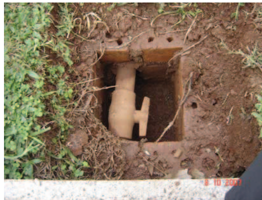
Figura 4.3 – Entrada da alimentação da ampliação do terminal.
