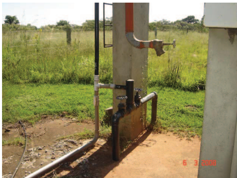
Figura 4.21 – Local de instalação do hidrômetro no sítio aeroportuário Lauro Kurtz.
