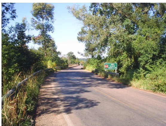
Figura 45: Foto da vista da Ponte sobre o Arroio Coitinho – entre a rodovia RS-124 e a Rua Sete de Setembro (2006)
