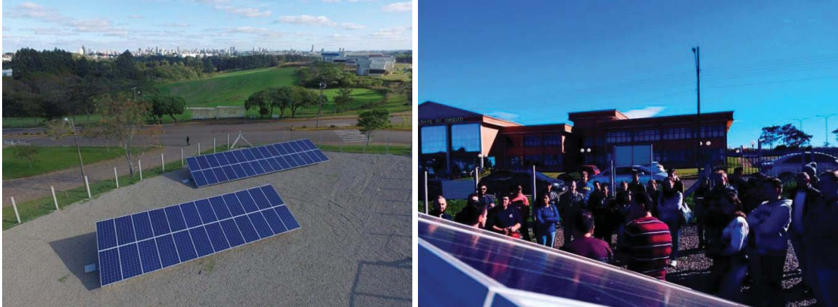
Figura 29 - Parque de Geração Solar Fotovoltaica da Universidade de Passo Fundo
