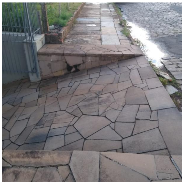
B) Ausência de acessibilidade pela criação de um acesso de veículos
