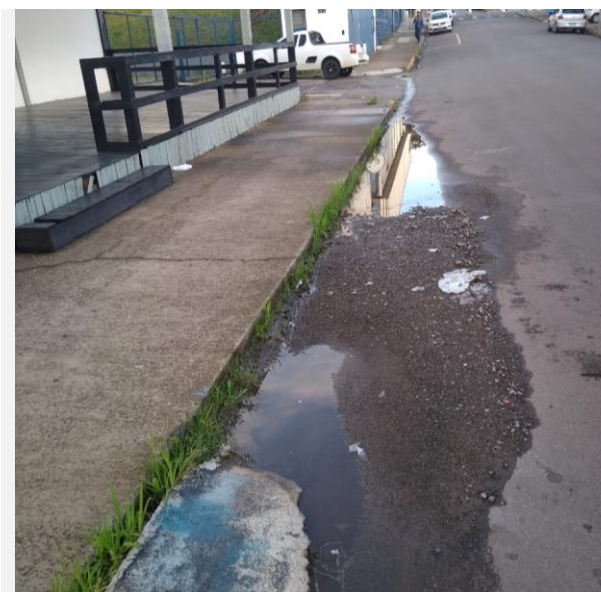
C) Local com carreamento de solo e interferência do escoamento no fluxo de pedestres.
