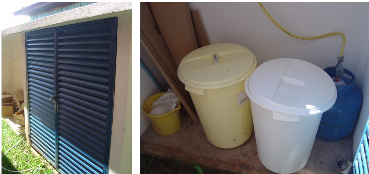
Figuras 115 e 116 – Central de GLP utilizada de modo indevido.
