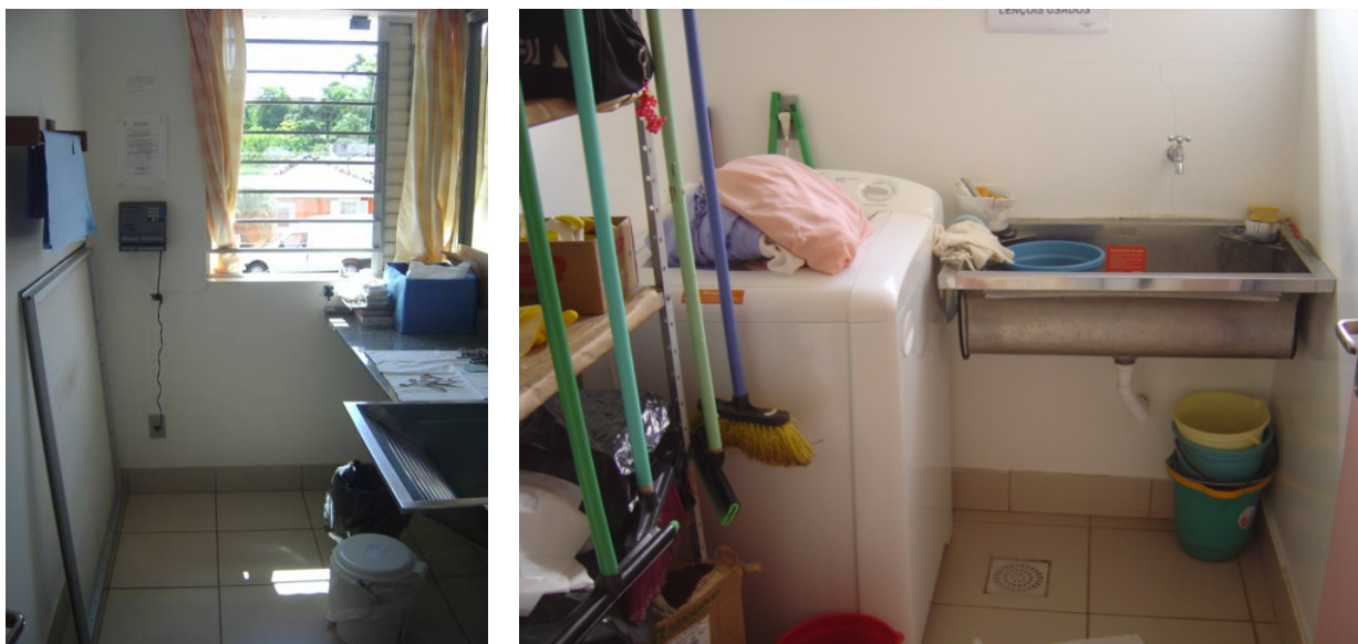
Figura 121 – Sala de expurgo / ponto eletrônico instalado em local impróprio.
