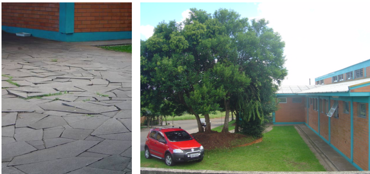
Figura 63 – Calçamento externo de acesso ao CAIS / pedras soltas.
