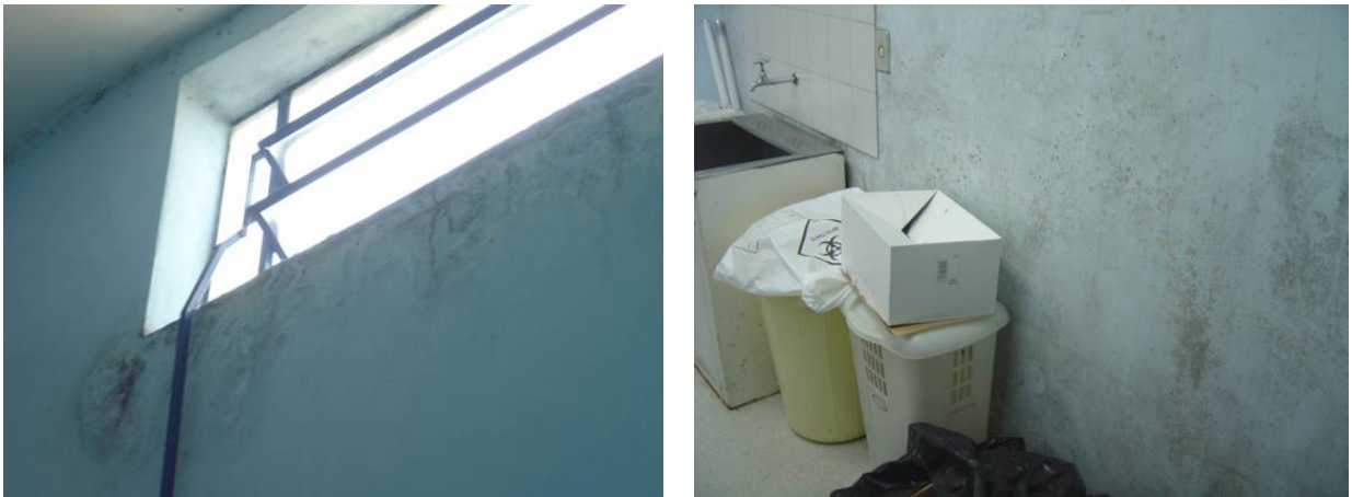
Figura 20 – Circulação social iluminada por sheds / freqüentes infiltrações.
