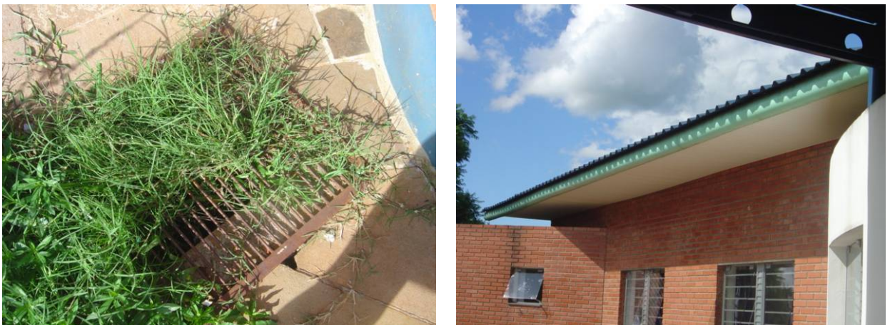
Figura 86 – Caixa coletora pluvial entupida por vegetação e falta de manutenção.
