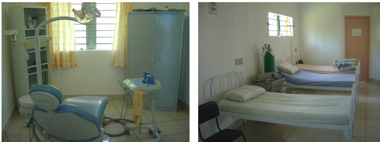
Figura 138 e 139 – Consultório odontológico e sala de observação / vãos de iluminação insuficientes.
