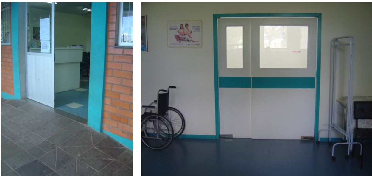
Figura 74 – Rampa de acesso principal / declividade desconforme a NBR 9050.
