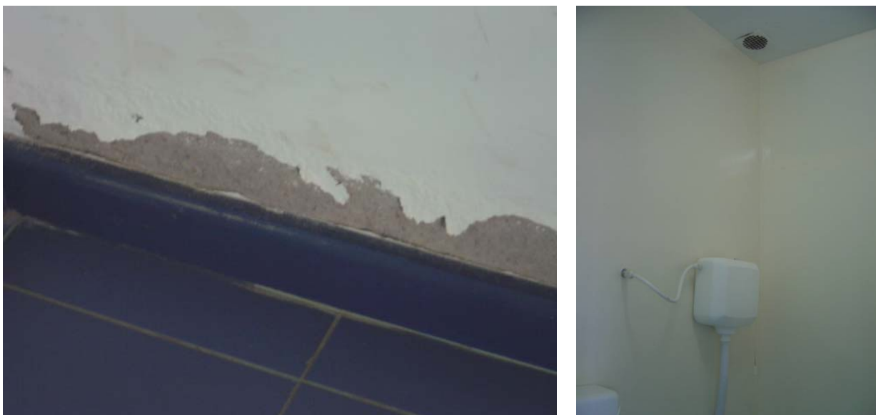
Figura 101 – Eflorescências encontradas nas paredes de alvenaria.
