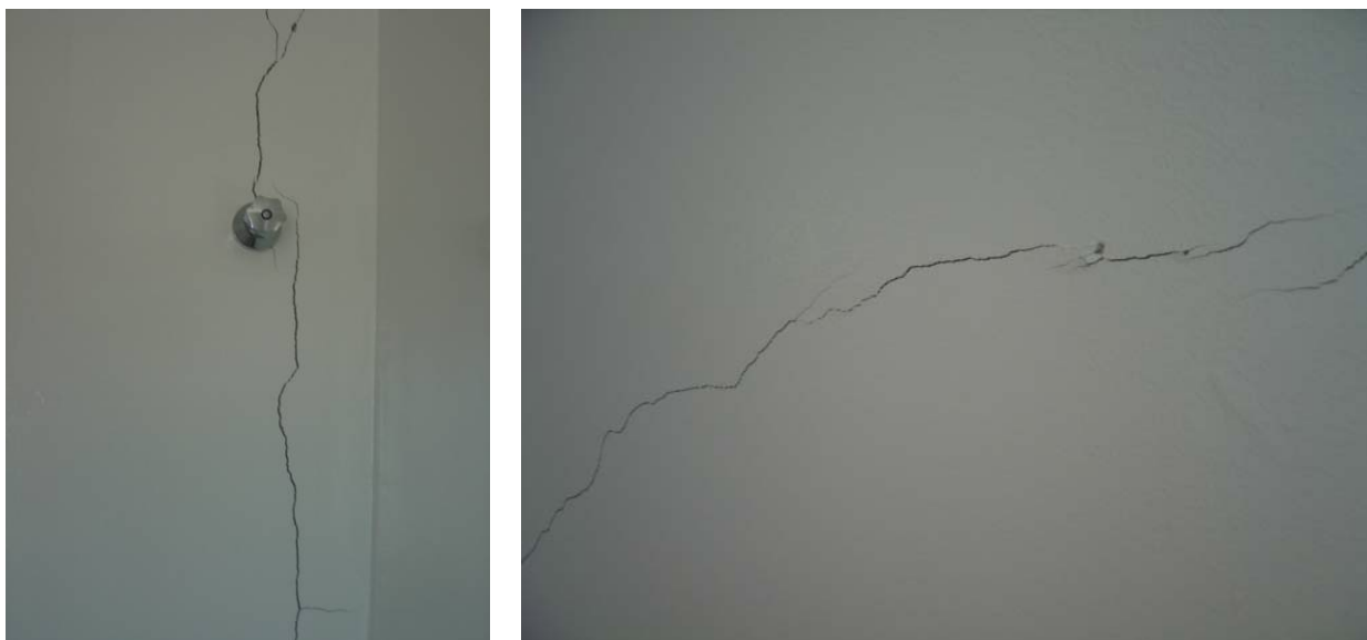
Figuras 128 e 129 – Fissuras nas paredes dos banheiros situados nas extremidades da edificação.
