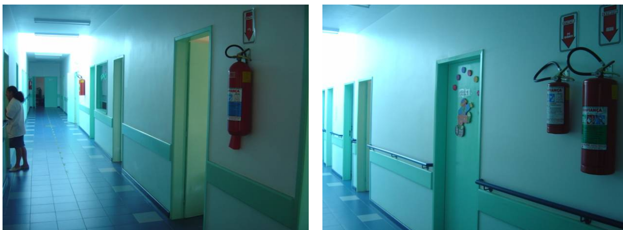
Figuras 109 e 110 – Extintores de incêndio instalados na circulação social.
