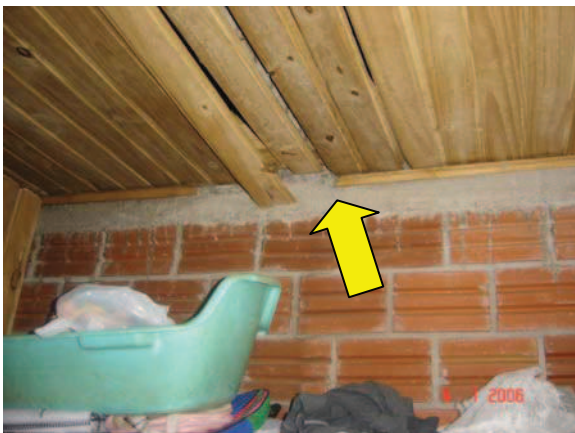
Figura 13 – Forro com problemas
