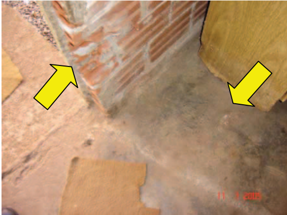
Figura 15 – Piso e quadro da porta mal acabado
