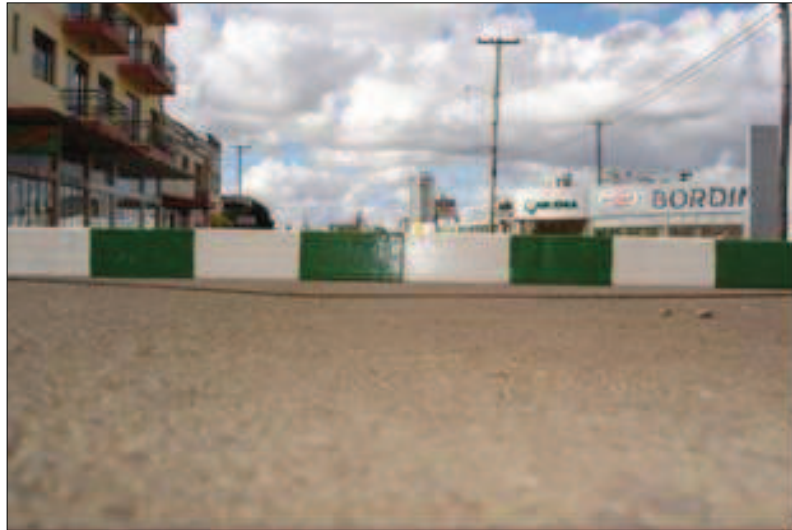
Figura 53 – Afundamento em trilha de rodas
