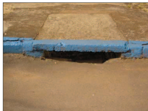
Figura 3 – Dispositivo de captação
