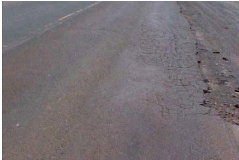
Figura 49 – Erosão de Bordo
