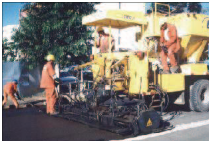
Figura 20 – Aplicação de MRA sobre pavimento deteriorado
