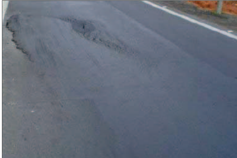
Figura 55 – Escorregamento de Massa
