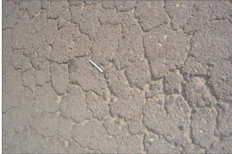
Figura 39 – Trincamento por Fadiga
