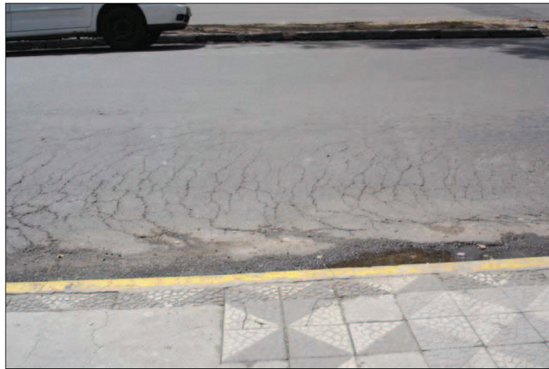
Figura 44 – Trincas de Escorregamento
