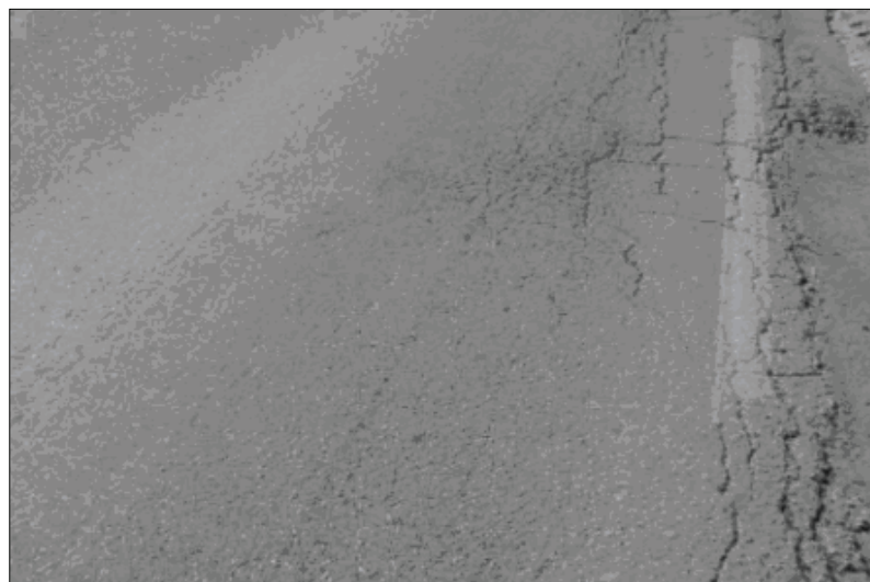
Figura 45 – Trincas de bordo
