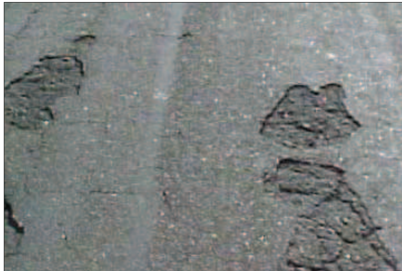
Figura 51 – Deslocamento da Capa Selante
