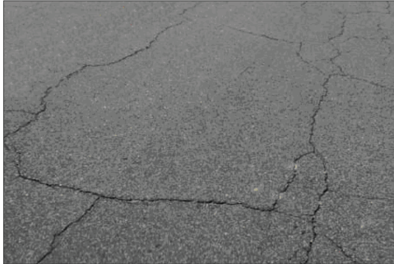
Figura 40 – Trincamento em Bloco
