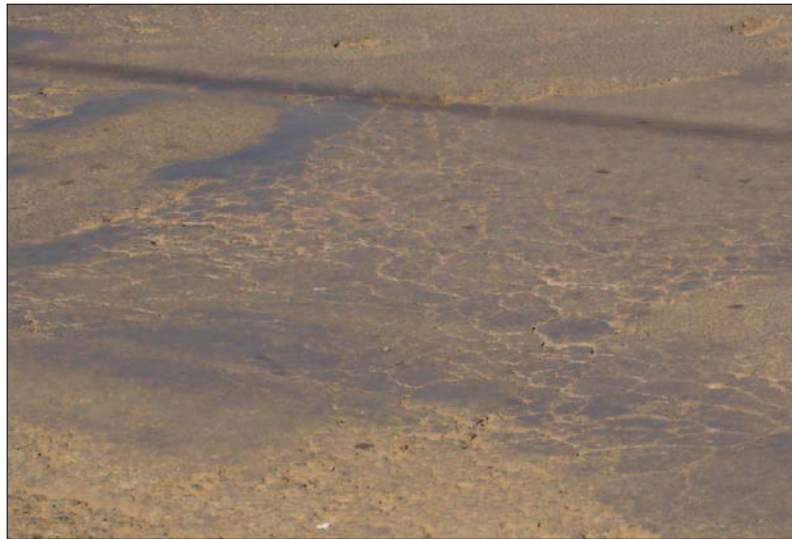
Figura 41 – Trincamento por Reflexão
