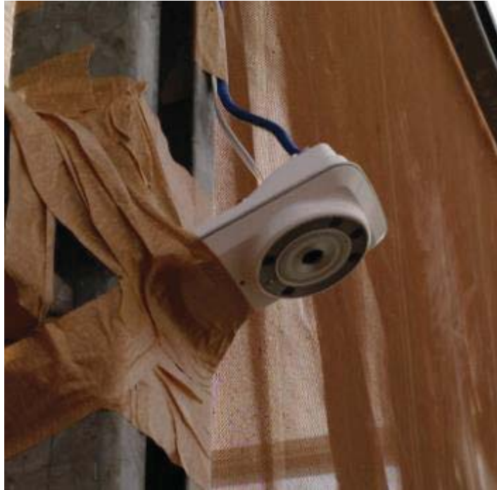
Figura 46. Câmera IP instalada.
