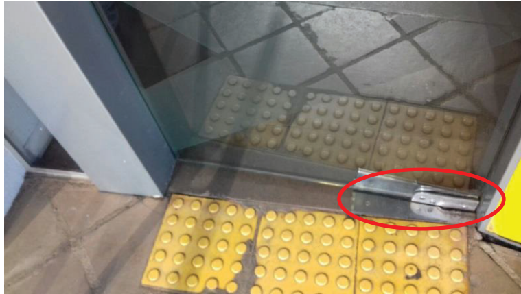
Figura 30: Detalhamento da mola de piso avariada.
