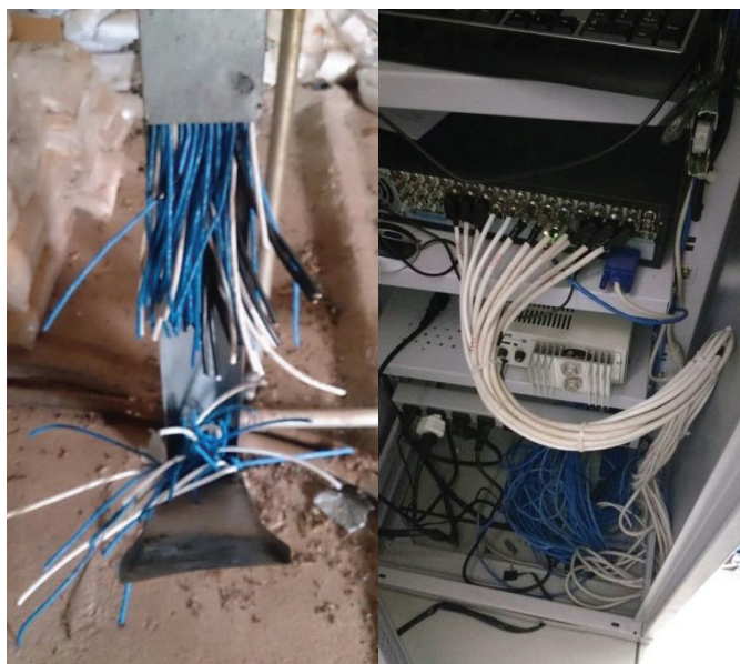
Figura 26: Cabeamento estruturado avariado e após a sua substituição a) Cabeamento estruturado avariado b) Cabeamento estruturado substituído
