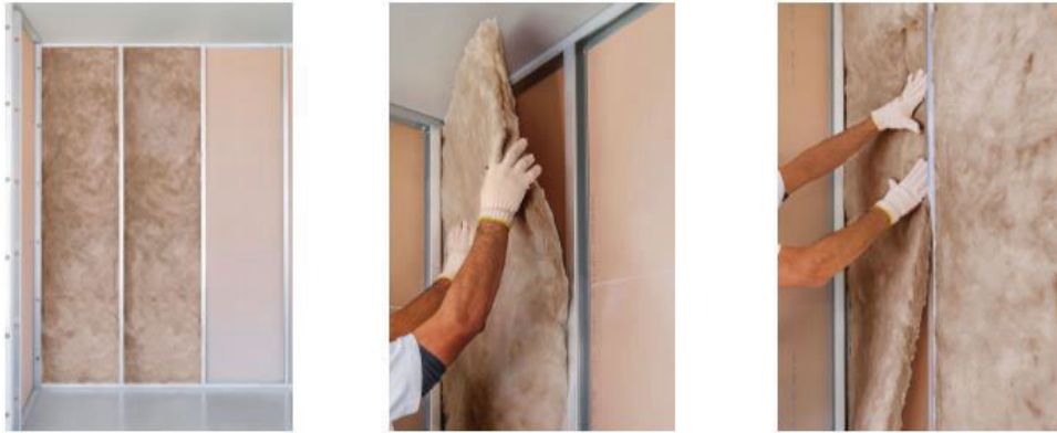
Figura 63: Isolamento com lã de vidro
