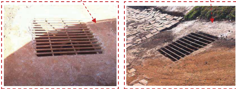
BOCA DE LOBO 1
