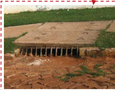
BOCA DE LOBO 2
