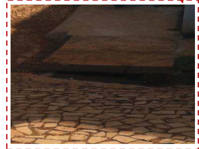
BOCA DE LOBO 3
