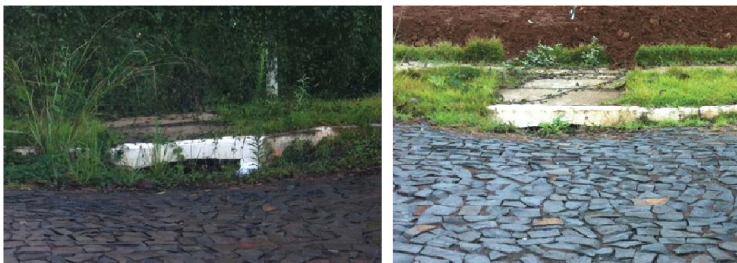
Figura 61 - Bocas de lobo da Rua "A" – Primeiro entroncamento - Villaggio
