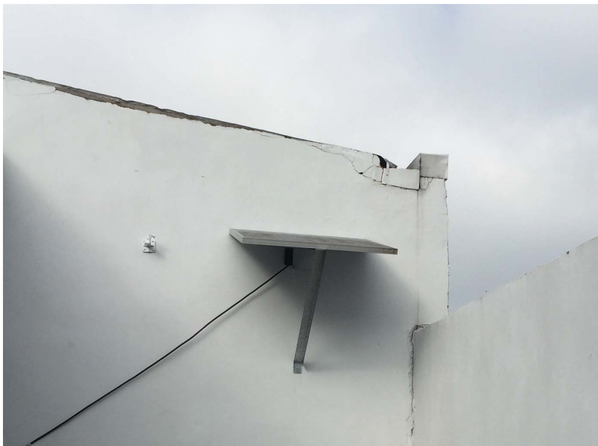
Figura 56: Instalação Experimental do Painel Solar Fotovoltaico
