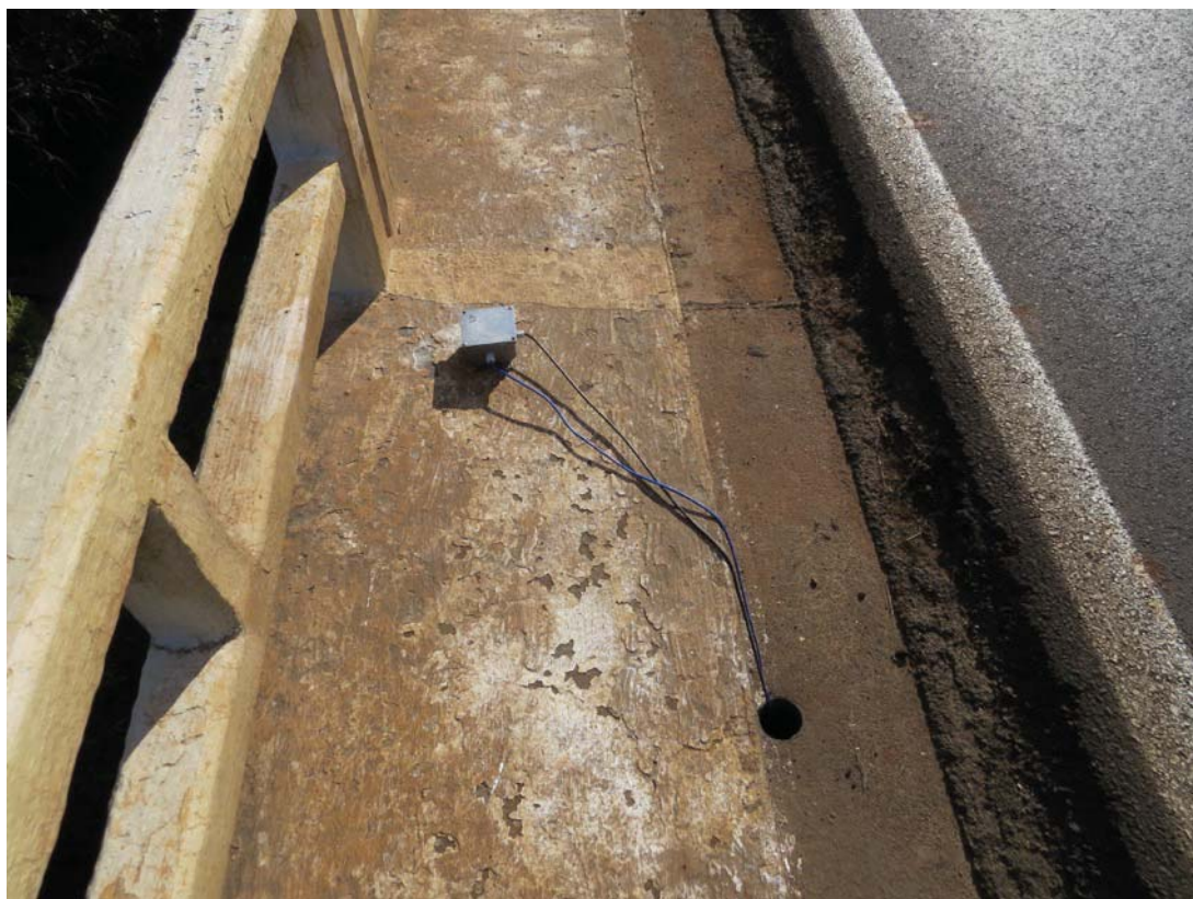
Figura 60: Passagem dos Cabos pela Pingadeira no Viaduto
