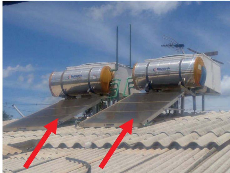
Figura 23 - Coletor solar ONIX instalado em duas unidades habitacional.
