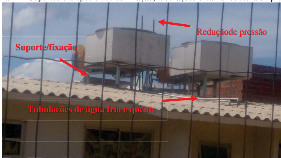
Figura 24 - Suportes e dispositivos de fixação, tubulações e caixa redutora de pressão.
