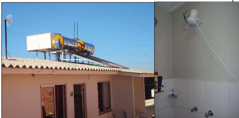
Figura 30 - Coletores solares e chuveiro instalados na unidade habitacional do pré-teste.
