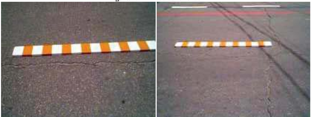
Figura 19 - Trinca de reflexão
