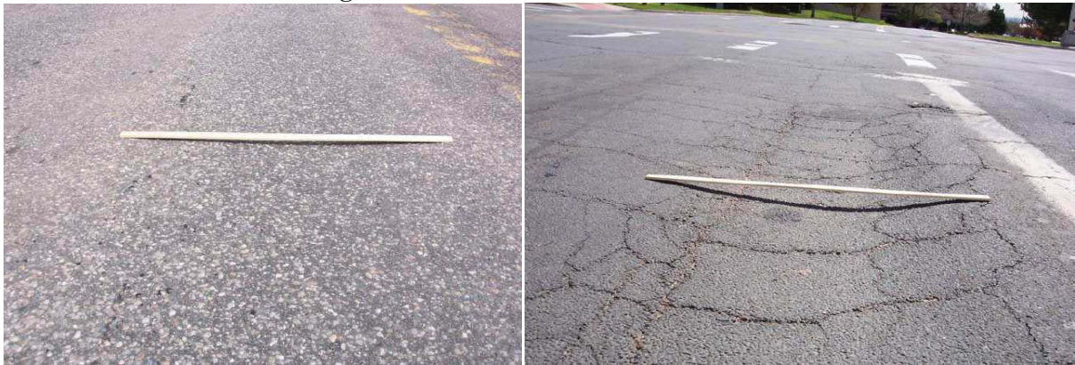
Figura 3 - Afundamento em trilha de roda
