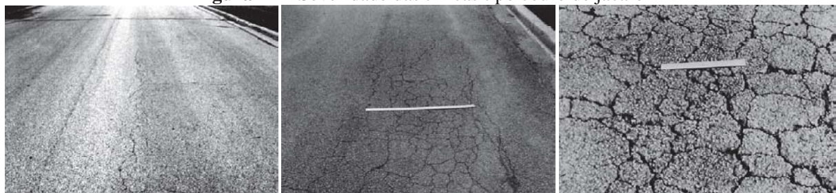
Figura 21 – Severidade das trincas tipo couro de jacaré
