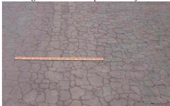
Figura 20 - Trinca tipo couro de jacaré
