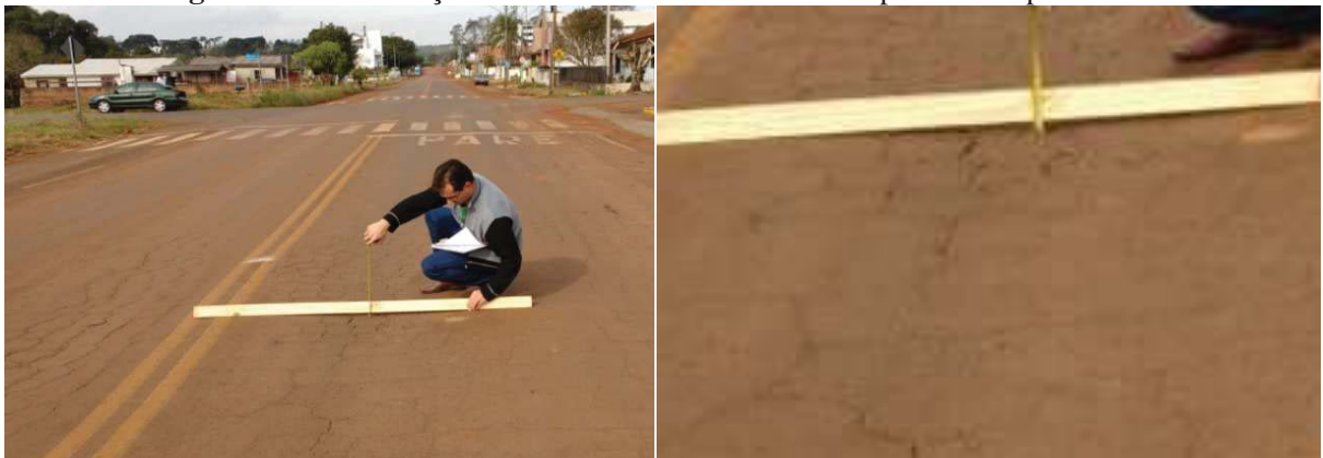
Figura 35 – Verificação da severidade de defeitos na superfície do pavimento
