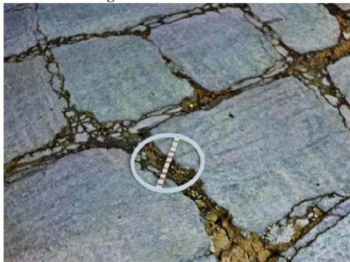
Figura 14 - Trinca de bloco
