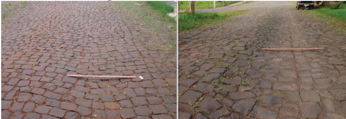
Figura 25 - Afundamento em trilha de roda
