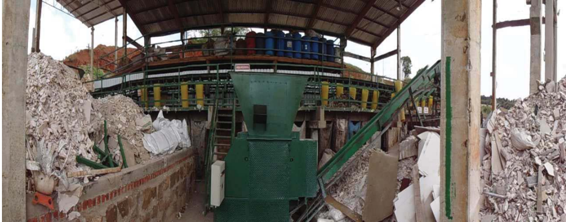
Figura 19: Esteira de separação e local de armazenamento dos materiais reciclados
