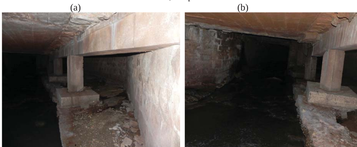
Figura 63 – (a) e (b) Bolsão no encontro das galerias dos arroios Caramirim e Ibirapuitã, sob a rua 15 de Novembro, nos pontos 14 e 15.
