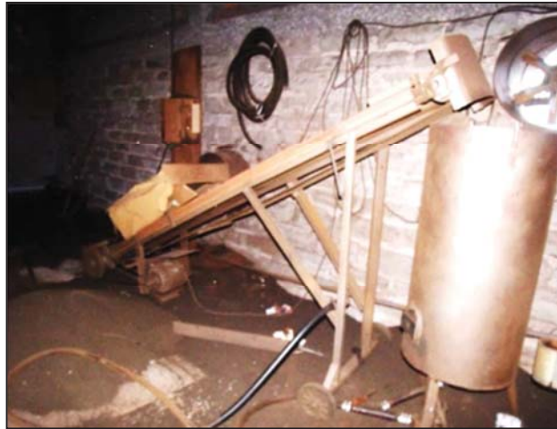
Figura 75 - Equipamento do jato de granalha.
