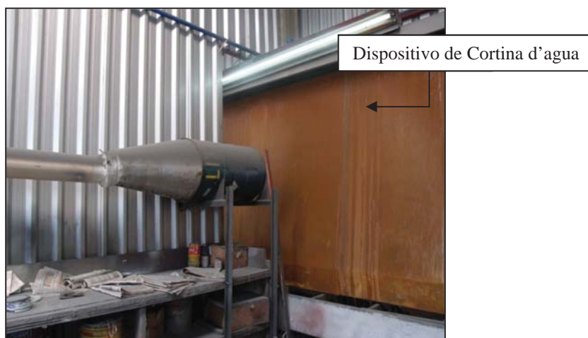
Figura 85 - Dispositivo cortina de água
