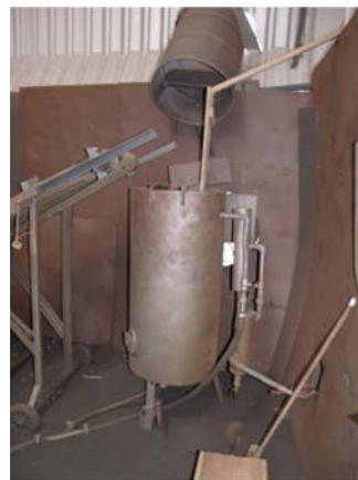
(b) Setor de jato de granalha novas instalações
