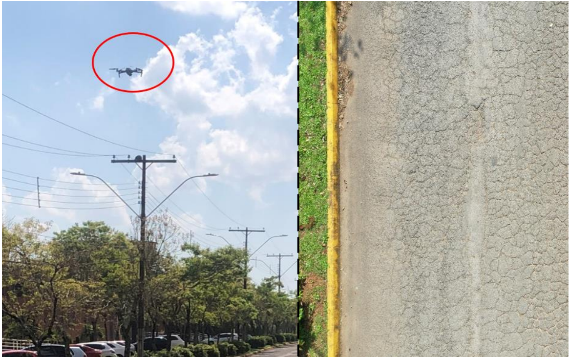
Figura 12 – Voo drone / Trinca em via pavimentada
