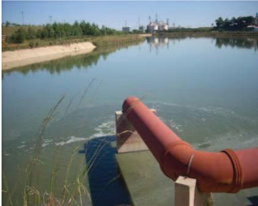
Figura 25: Lagoa Anaeróbia da ETE Araucárias.
