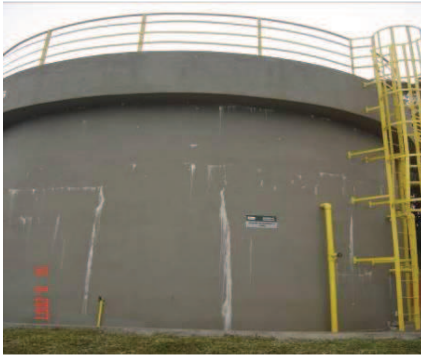
Figura 19: Reator UASB da ETE da UPF.
