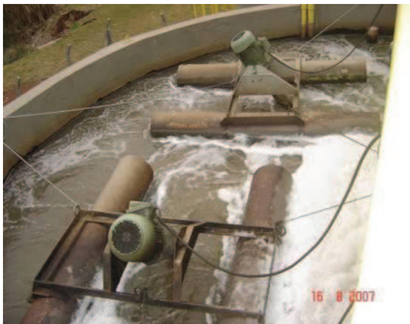
Figura 18: Conjunto moto-bomba do tanque de acúmulo.
