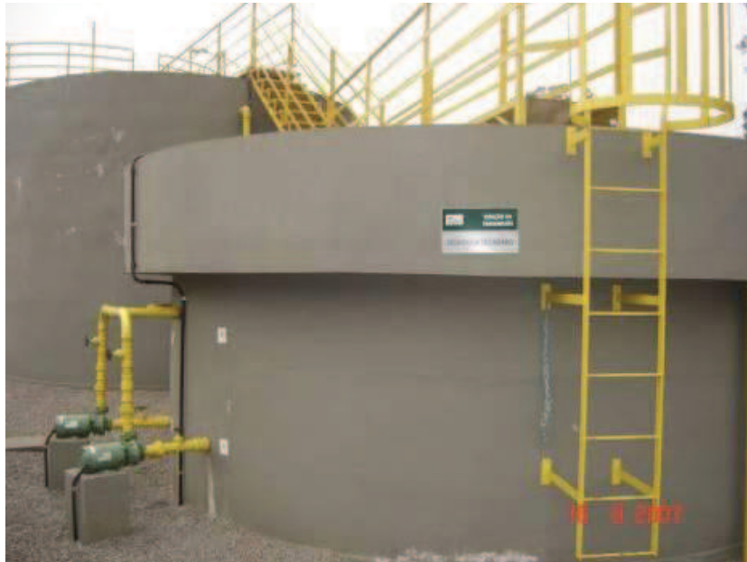
Figura 21: Decantador Secundário da ETE da UPF.
