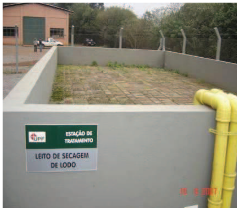
Figura 22: Leito de Secagem de lodo da ETE da UPF.
