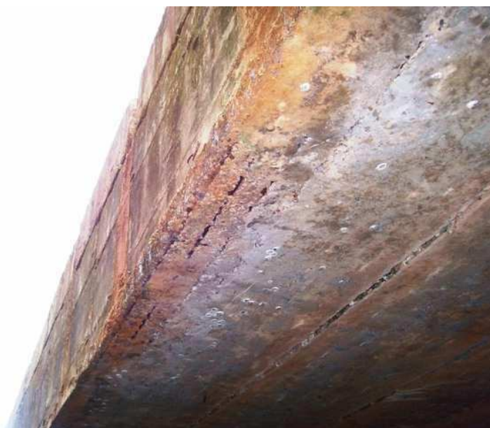
FIGURA 45 - Corrosão de armadura da viga lateral da ponte (Ponte P129)
