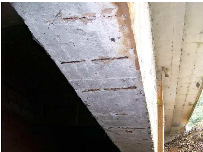
FIGURA 47 - Exposição de armadura de estribo (Ponte P151)
