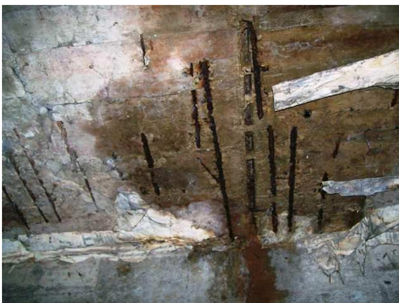
FIGURA 50 - Corrosão da armadura nas bordas da junta de dilatação da ponte (Ponte P155)
