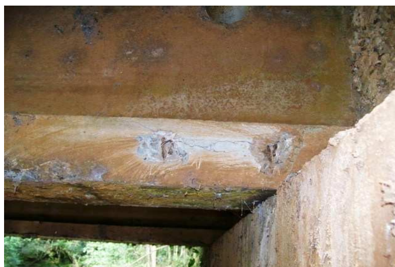
FIGURA 46 - Deslocamento do concreto com exposição da armadura (Ponte P145)
