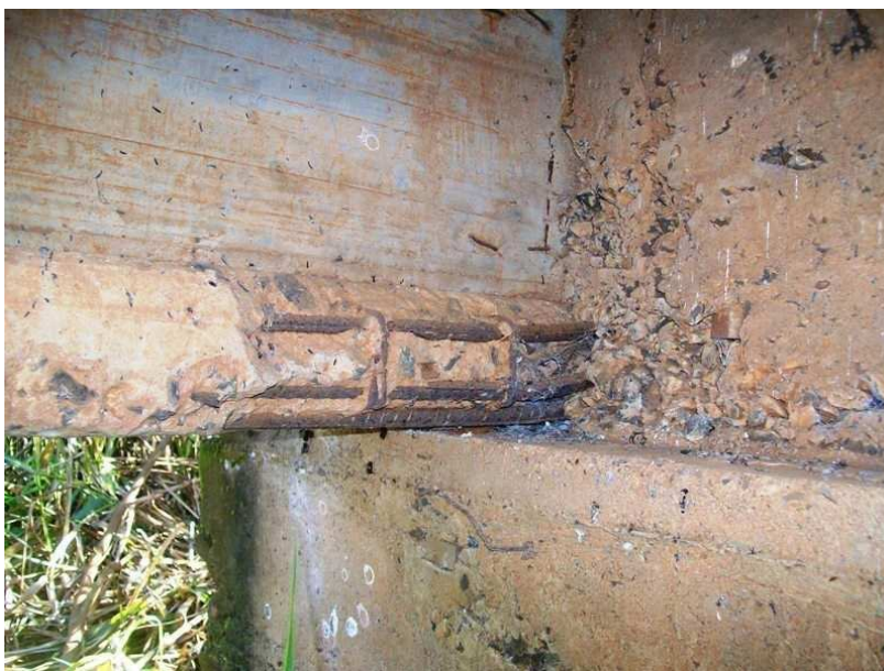
FIGURA 51 – Armadura exposta na viga pré-moldada (Ponte P103)
