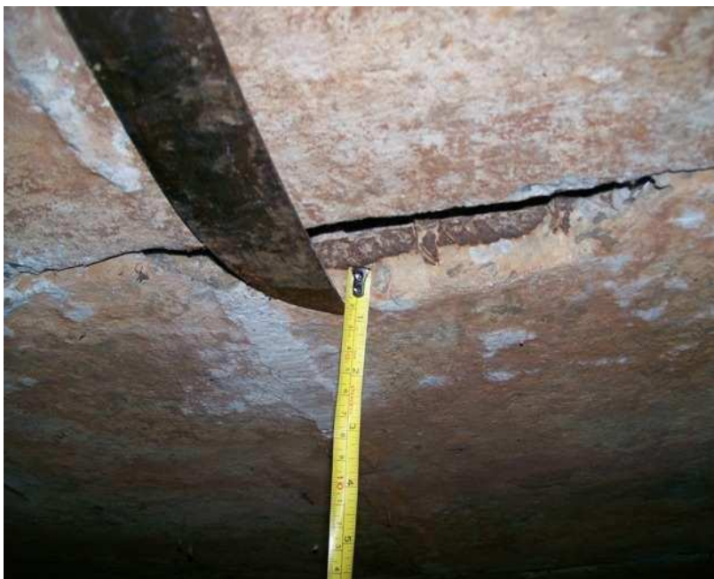
FIGURA 55 - Cobrimento de armadura (Ponte P126)
