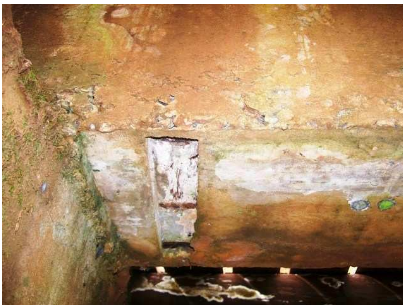
FIGURA 53 - Armadura exposta (Ponte P121)
