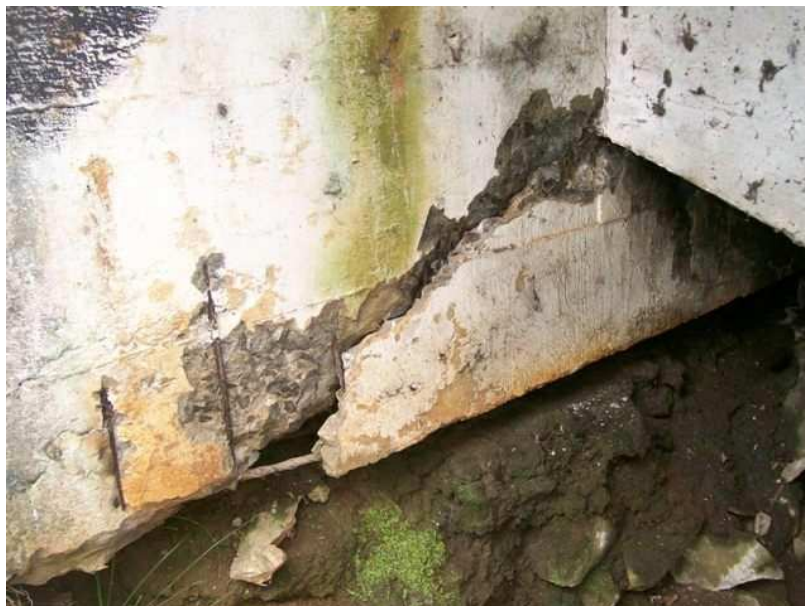
FIGURA 57 - Rompimento do balanço de acesso da estrutura da ponte (Ponte P151)
