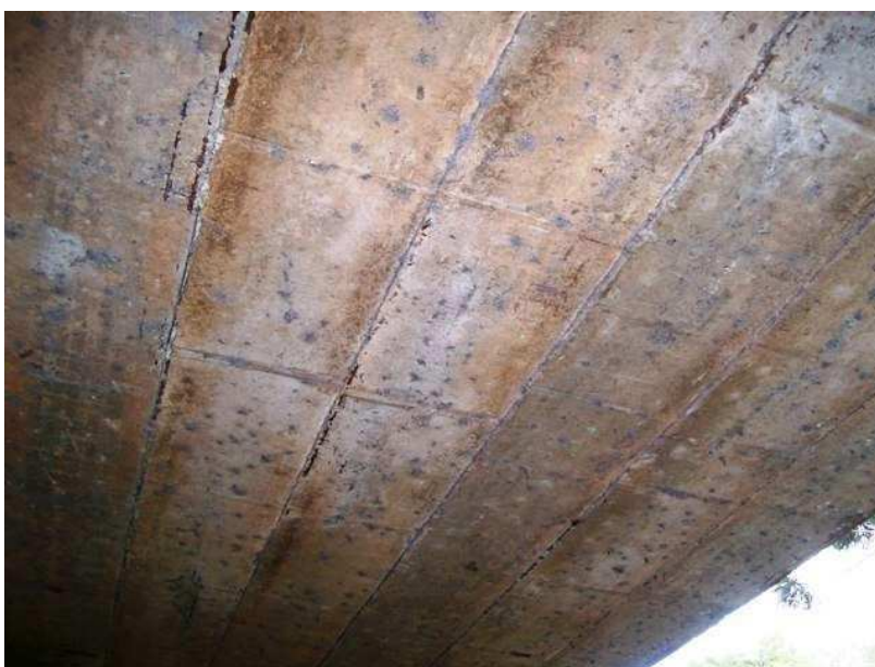
FIGURA 54 - Ninhos de concretagem (Ponte P129)
