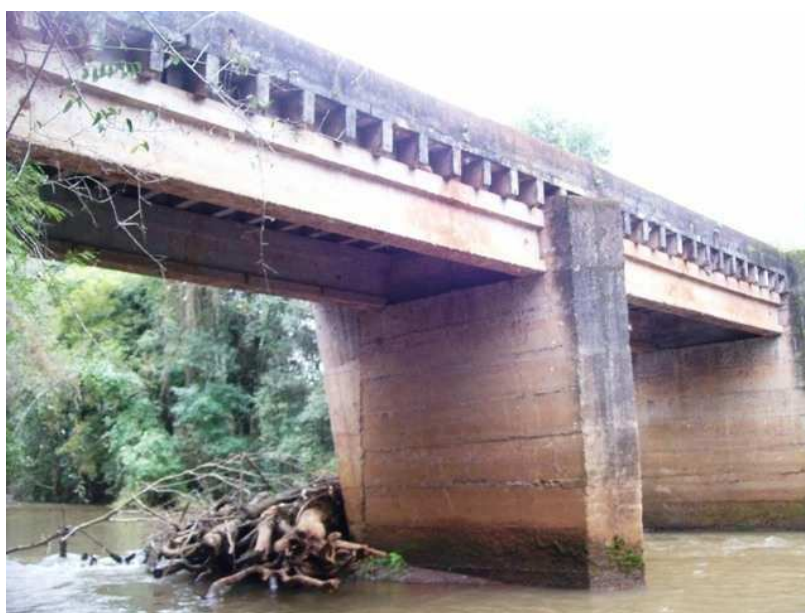
FIGURA 58 - Troncos de árvores impactando no pilar (Ponte P110)
