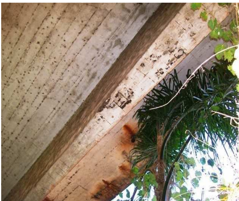
FIGURA 56 - Ninhos de concretagem na face inferior da longarina (Ponte P148)
