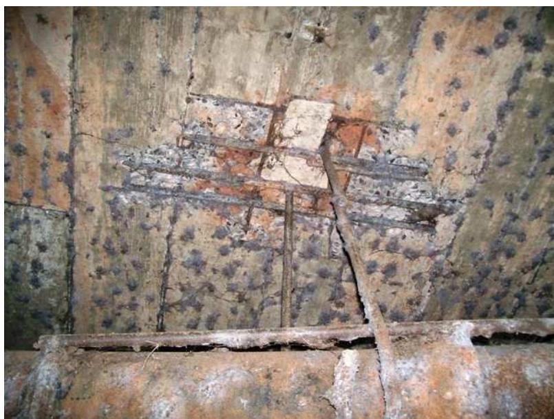
FIGURA 48 - Detalhe de fixação de tubulações na laje da ponte (Ponte P156)
