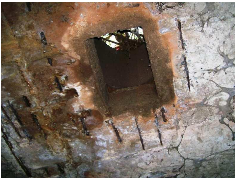
FIGURA 49 - Vista inferior da laje no acesso de drenagem das águas pluviais (Ponte P155)
