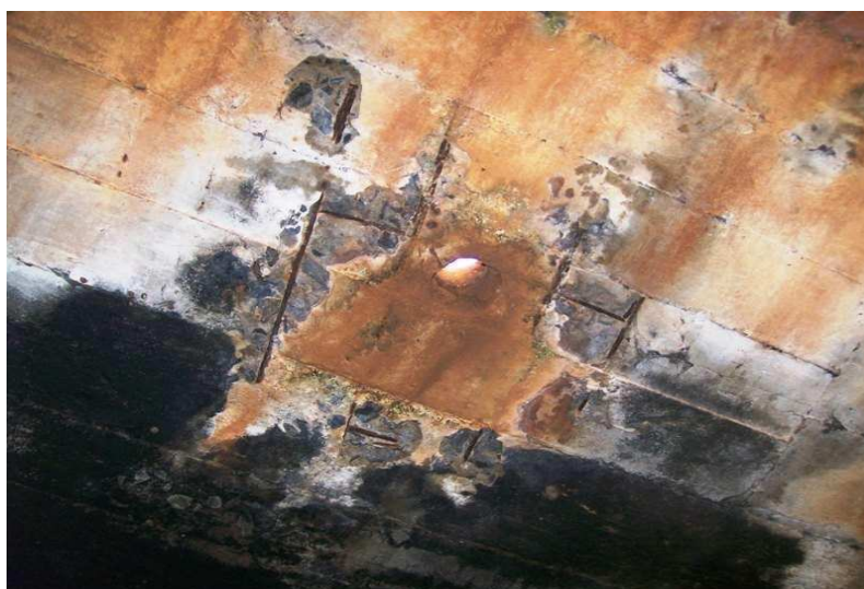
FIGURA 44 - Deslocamento de concreto e corrosão de armadura (Ponte P148)
