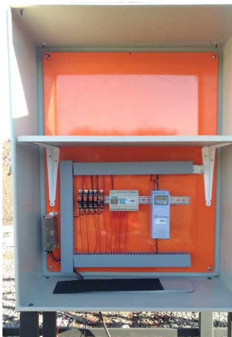
Figura 22 – Quadro de comando equipamentos auxiliares
