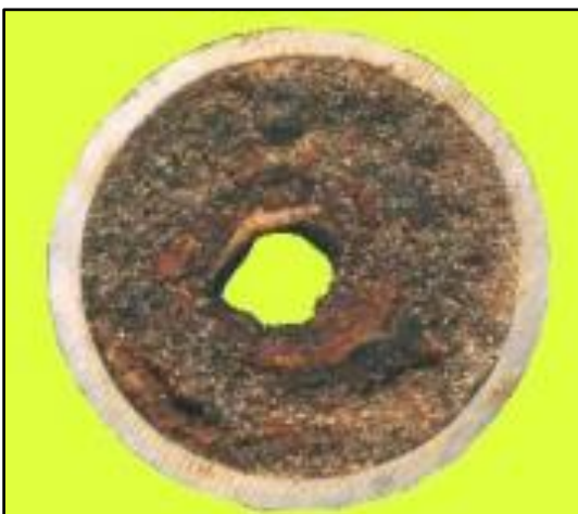
Figura 1 - Entupimento causado por deposição de orgânicos pesados .
